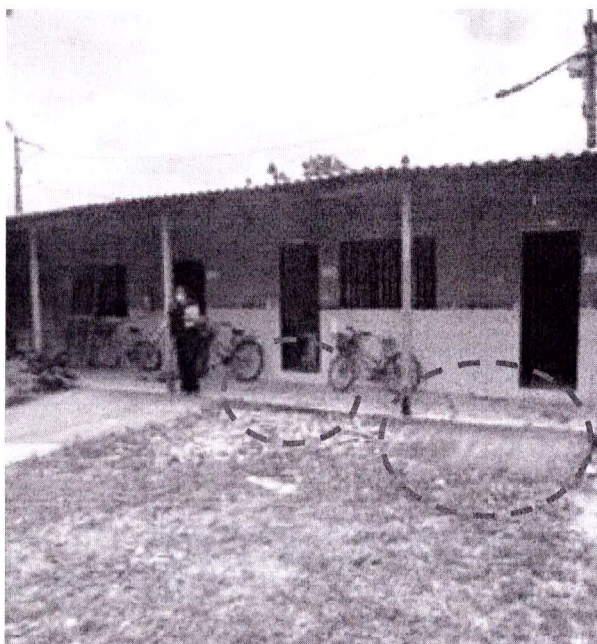
Figura 9 - Rampa de Acessibilidade ingreme, nível do piso elevado a sala de aula.
