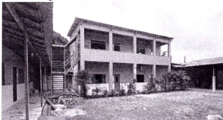
Figura 11 – Coberturas do imóvel sem calhas.
