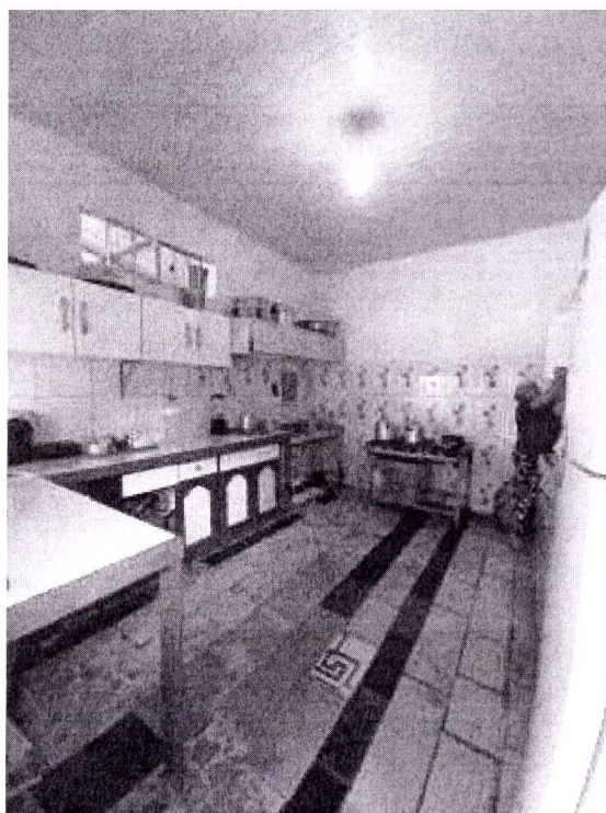
Figura 8 - Piso cerâmico liso desgastado cozinha
