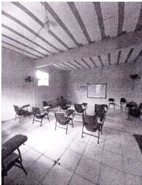
Figura 5 - Piso cerâmico liso desgastado sl aula
