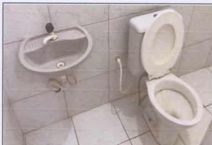
Foto 34: Detalhes das louças sanitárias instaladas no banheiro da sala 05.
