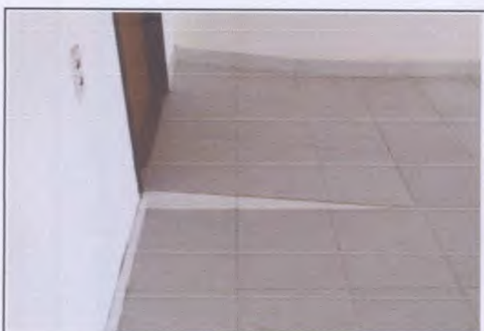
Foto 36: Rampa acessível localizada na entrada da sala 06.
