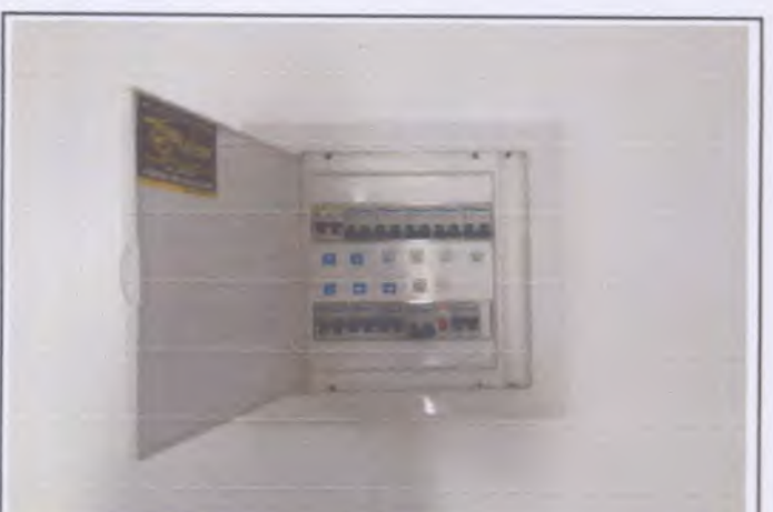
Foto 18: Quadro de distribuição, localizado na recepção.
