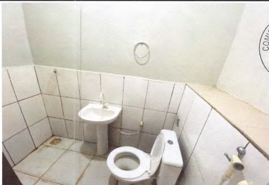
Foto 11: Banheiro 01 do Prédio Anexo.
