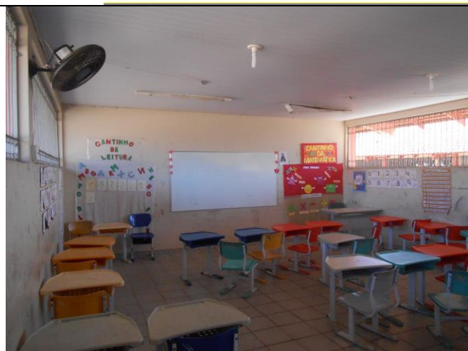
Foto 23 – Padrão de algumas salas. Forro pvc bastante danificado, janelas em gradil, lâmpadas fluorescente, ventiladores de paredes, piso cerâmico, pintura de paredes PVA fosca, lousa branca.
