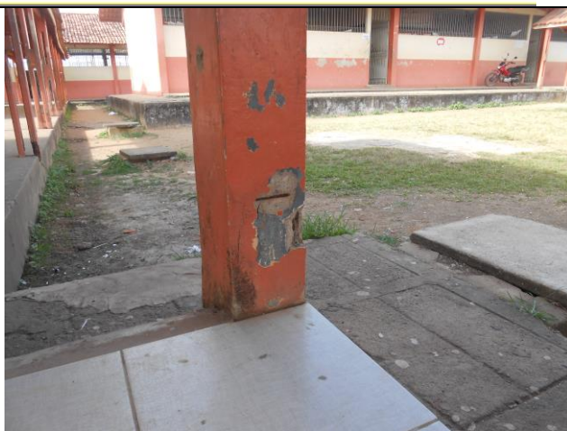
Foto 36 – Pilares em concreto com exposição de armaduras.
