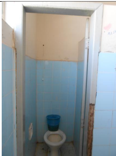
Foto 16 – Detalhes: portas e portais danificados.
