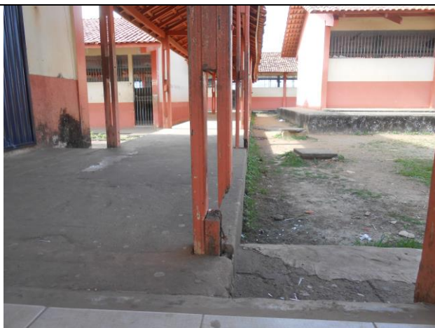
Foto 38 – Pilares em madeira, sanduíche, danificados.
