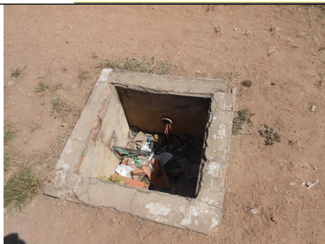
Foto 35 – Caixas de passagem elétrica.
