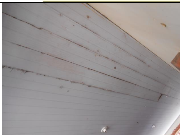
Foto 27- Forro pvc danificado.
