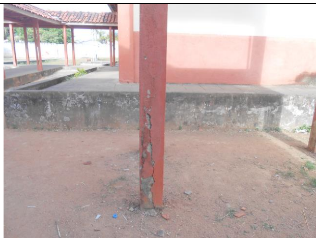
Foto 37 – Pilares em concreto com descascamento.
