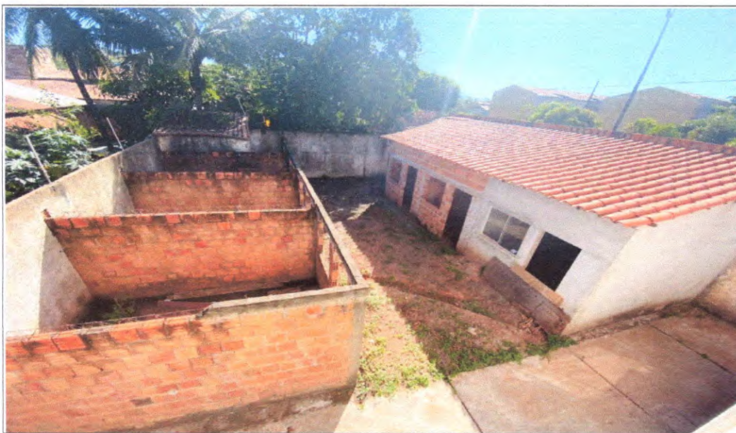
Foto 13: Área externa expondo uma construção inacabada.
