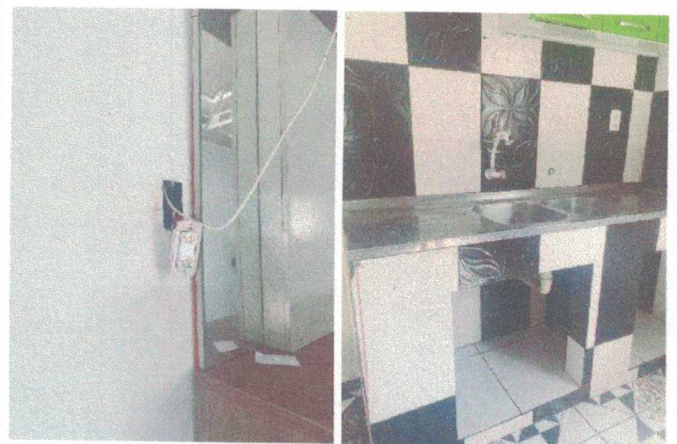
Detalhe(elétrica e hidráulica danificadas).
