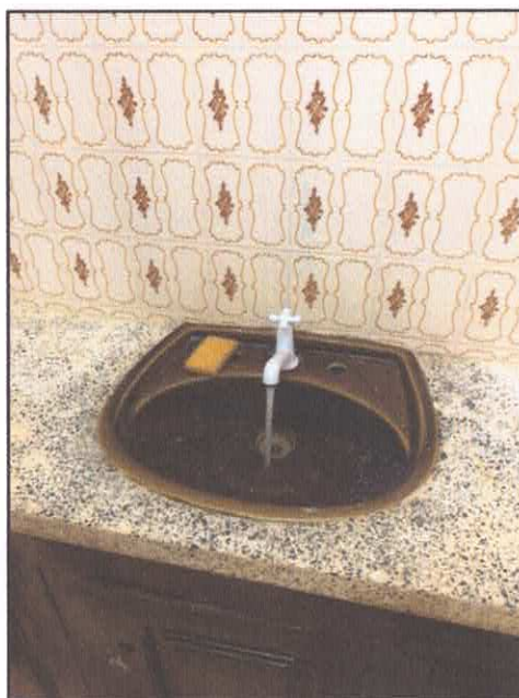
Figura 4: Instalações de Hidrossanitárias
