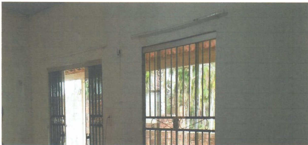
Foto 15 – Sala de reunião – parede e esquadrias
