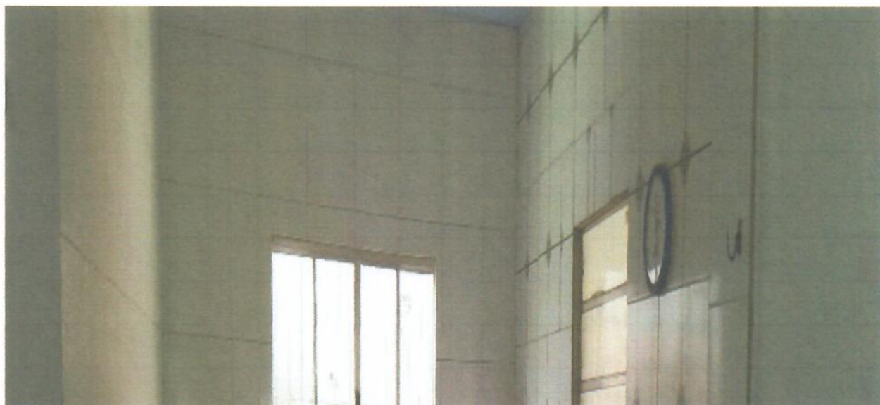
Foto 16 – Cozinha – parede e esquadrias
