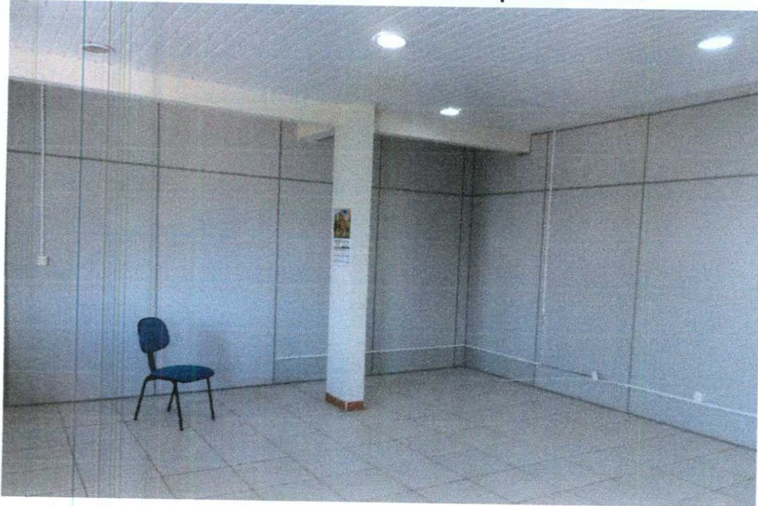
Foto 03 – Salão, cômodos dividido por divisórias.
