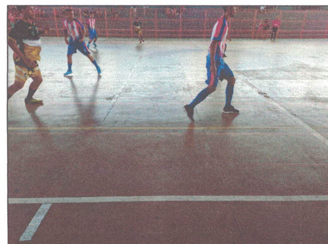
Foto 06: Piso em corundum revestido com tinta epóxi. Fonte: SEPLAN
