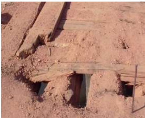
Foto 07 -Peças de madeira apodrecidas
