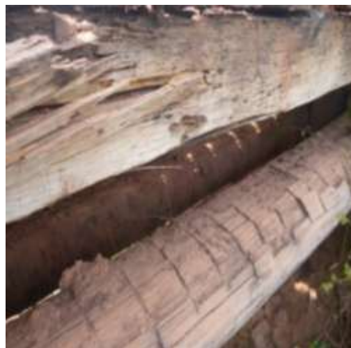
Foto 10 -Peças de madeira com rachaduras
