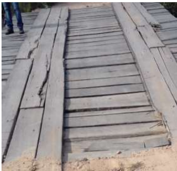
Foto 13- Pontes com rachaduras na mesa
