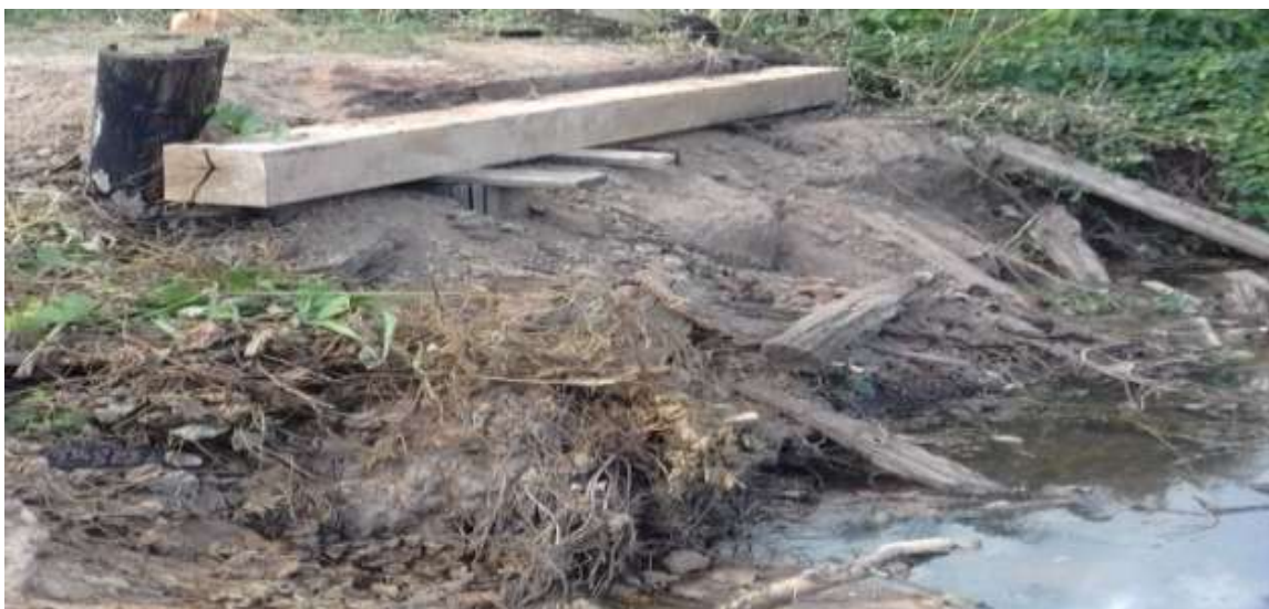
Foto 04 -Cabeceira de ponte que necessita de aterro
