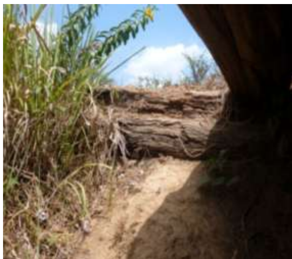
Foto 15- Apodrecimento nas transversinas das pontes
