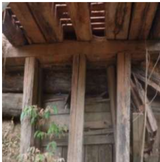
Foto 14- Fendilhamento nos pilares das pontes
