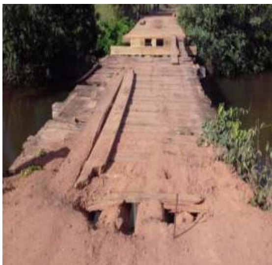
Foto 11 -Madeiras da mesa apodrecidas
