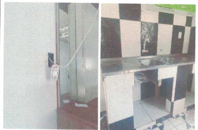
Detalhe(elétrica e hidráulica danificadas).
