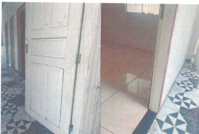
Detalhe (esquadrias danificadas).
