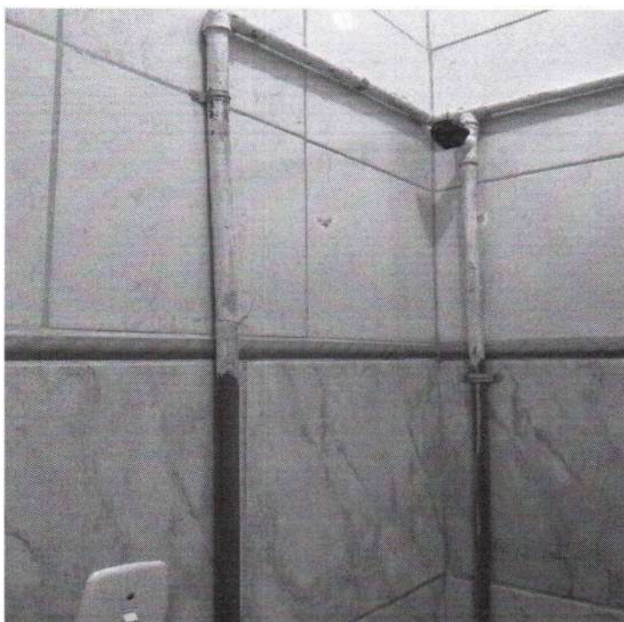
FOTO 03 – TUBULAÇÃO DE ÁGUA FRIA DO BANHEIRO DOS ALUNOS
