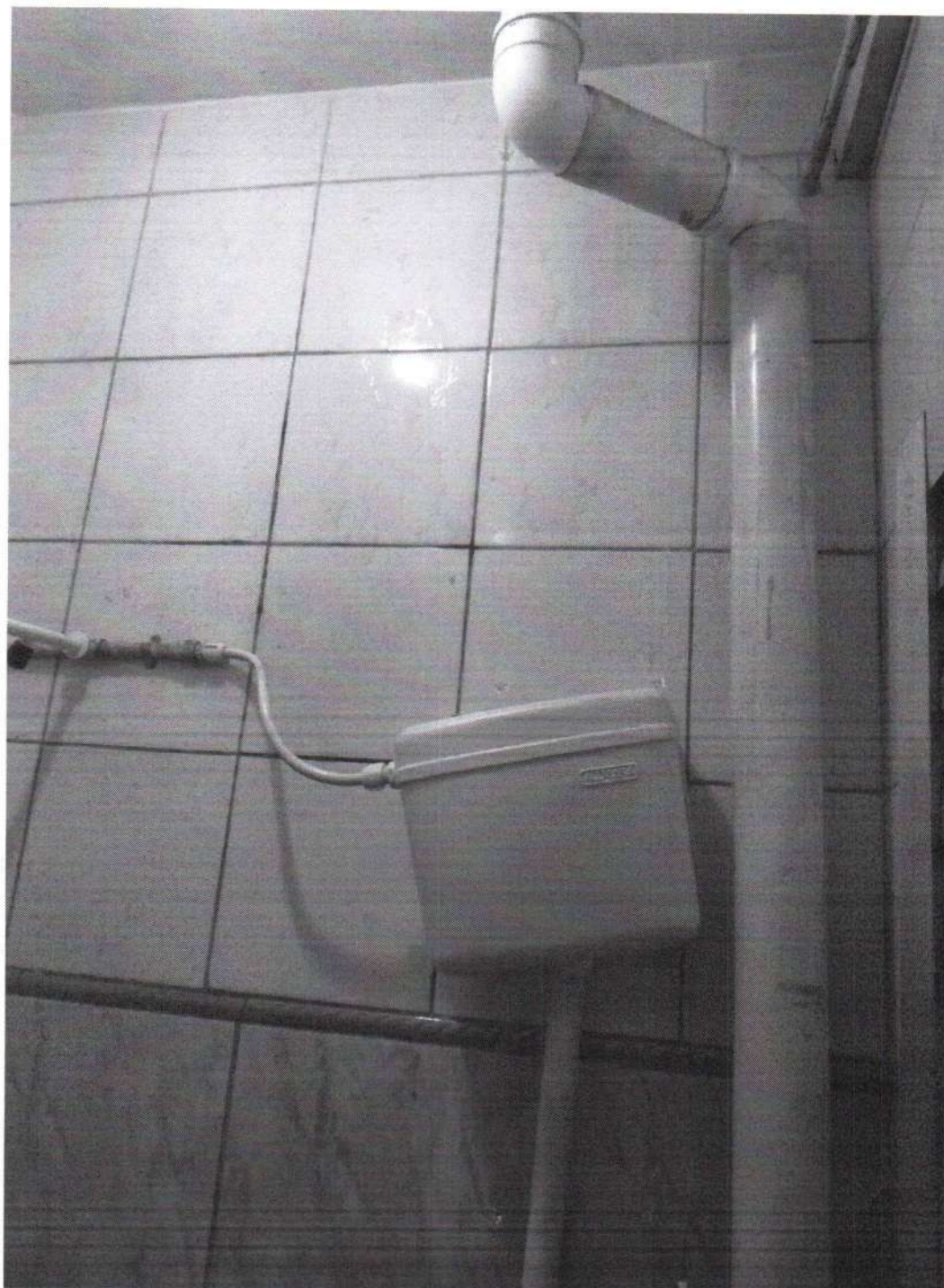
FOTO 04 – CAIXA DE DESCARGA COMPROMETIDO DO BANHEIRO DOS ALUNOS
