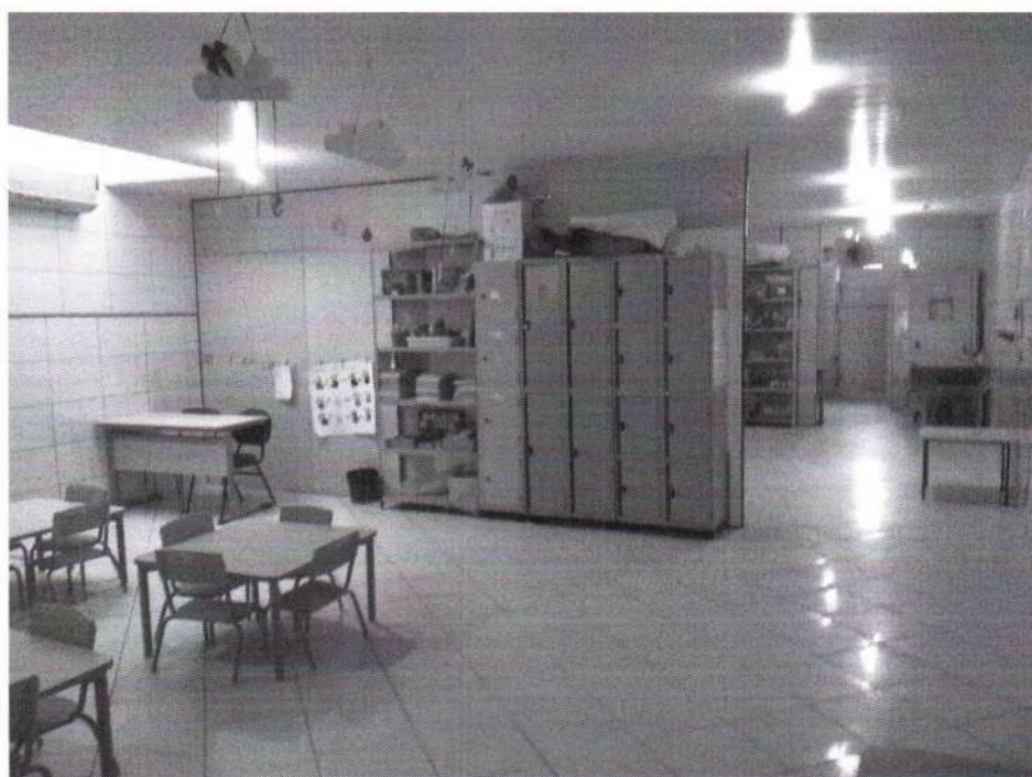
FOTO 06 – FALTA CONCLUIR AS DIVISÓRIA DAS SALAS – SEMEC
