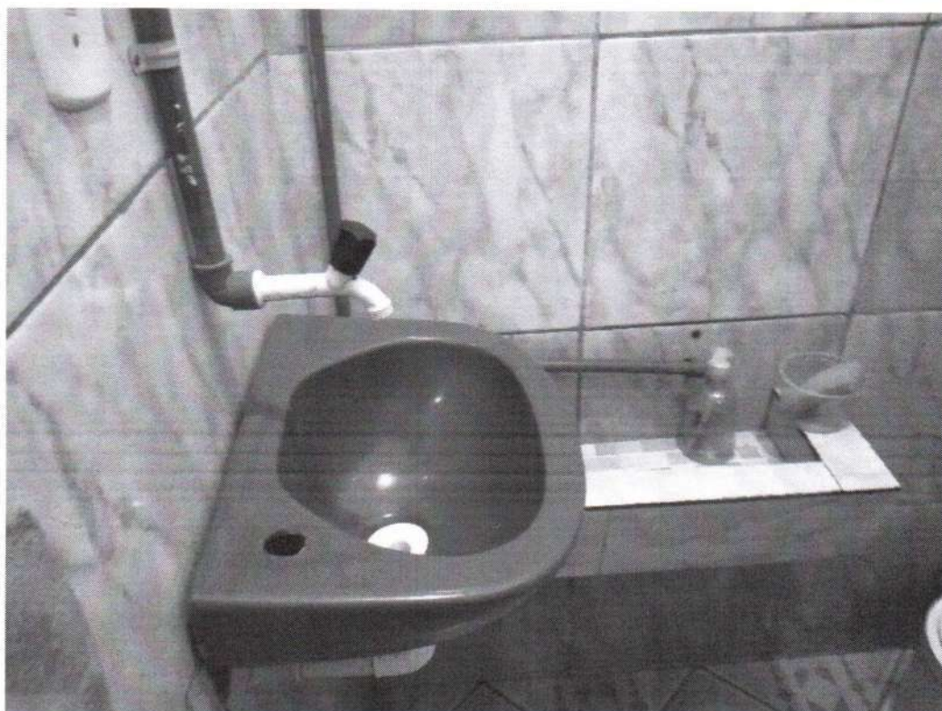
FOTO 02 – LAVATÓRIO E TUBULAÇÃO EXPOSTA BANHEIRO MASCULINO
