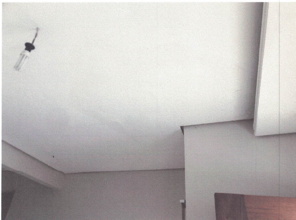
Imagem 12: forro da sala com sinais de umidade (infiltrações).
