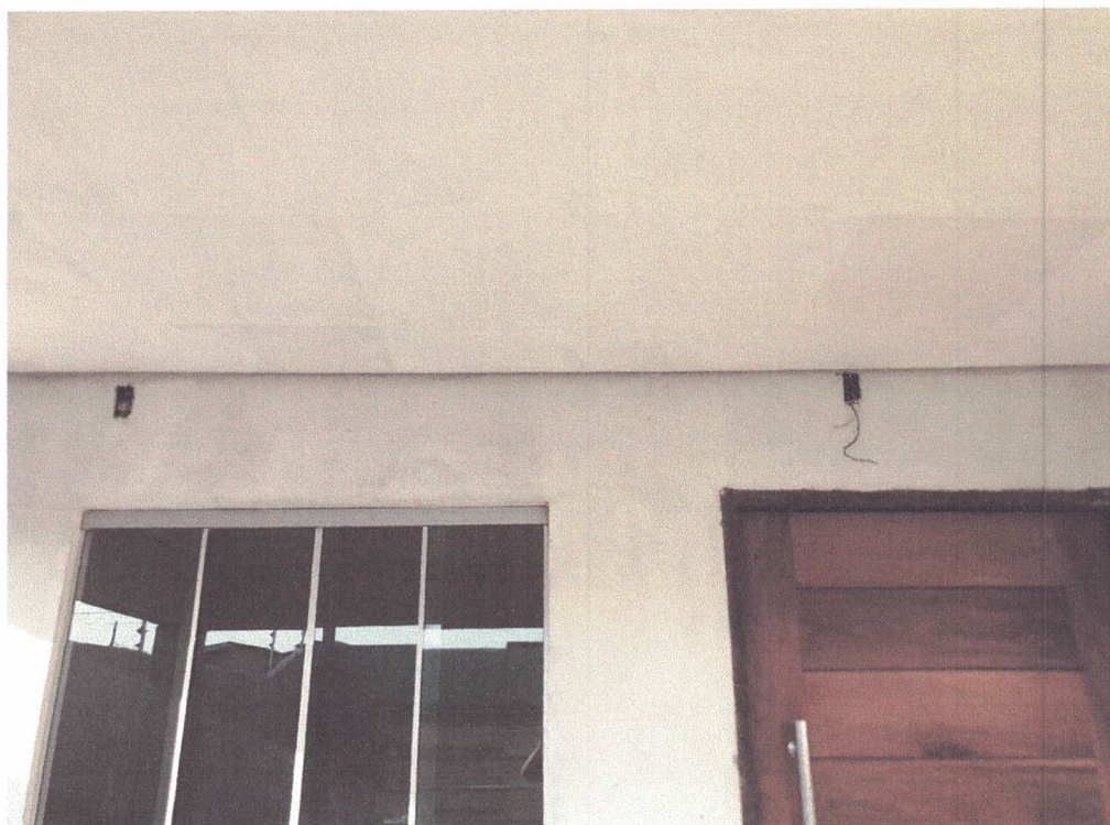
Imagem 08: garagem - forro, janela e porta (sem alisar) e instalações elétricas (com fiações expostas).
