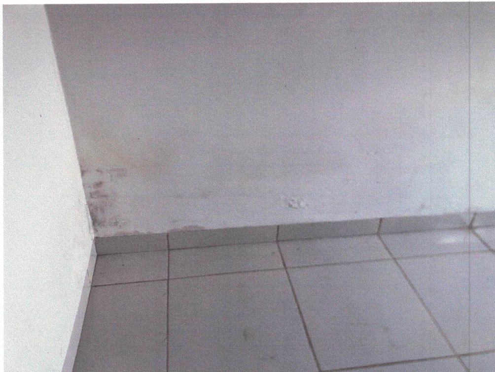
Imagem 16: parede com infiltrações do quarto.
