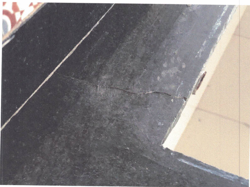
Imagem 50: cozinha – detalhe do granito da bancada de trabalho (quebrada e colada).
