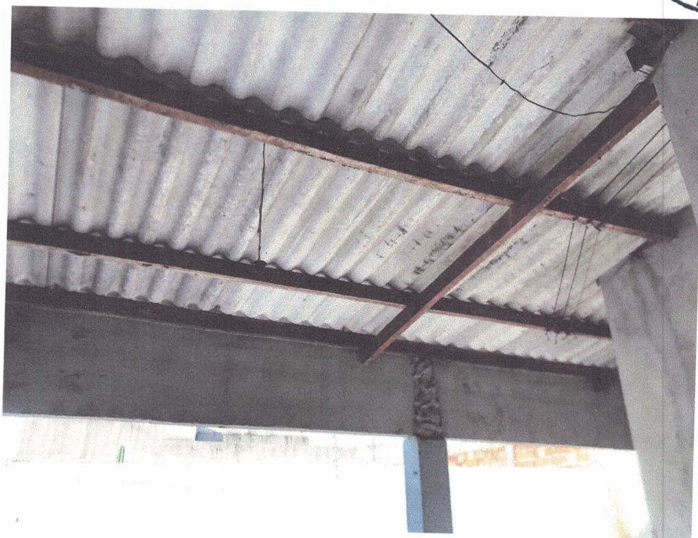
Imagens 61: telhado da varanda – fiações expostas.
