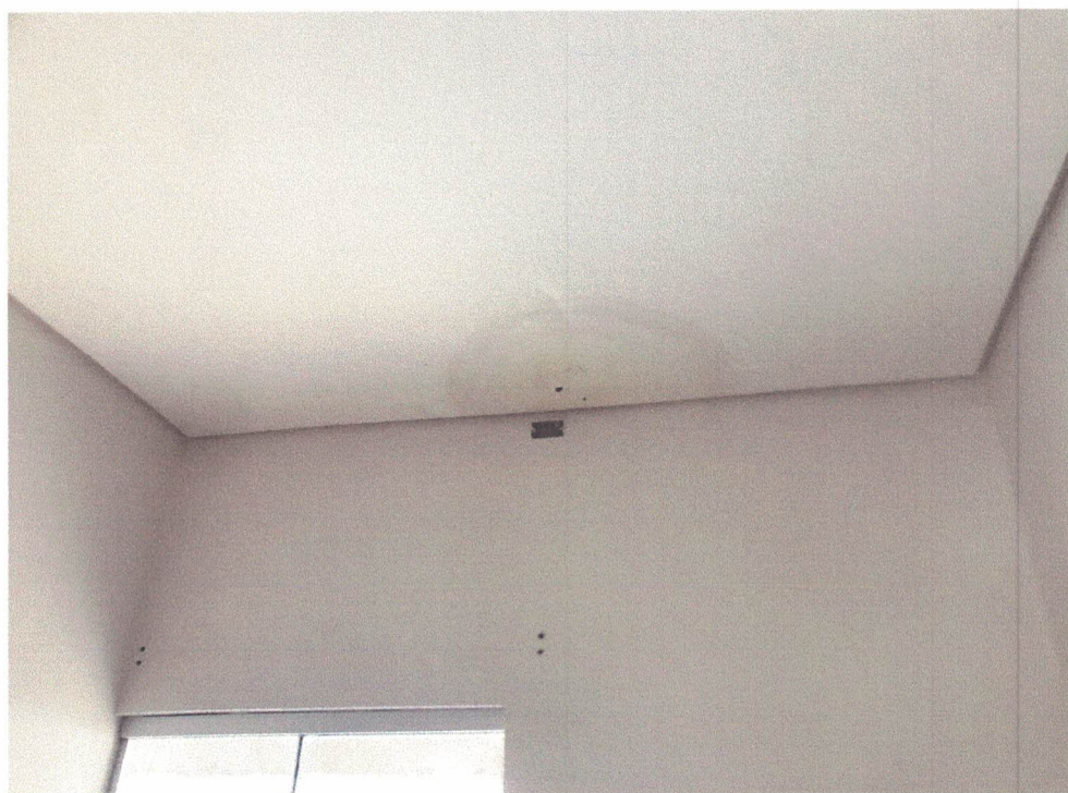
Imagem 24: infiltração no forro do quarto.
