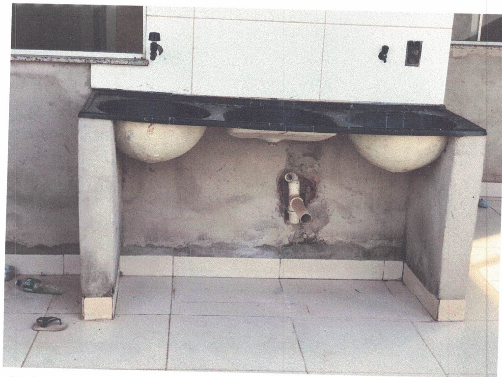
Imagem 65: área de serviço – instalações da tubulação de esgoto do tanque incompleta e caixa para tomada sem espelho (vedação).
