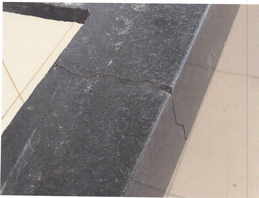
Imagem 51: cozinha – detalhe do granito da bancada de trabalho (quebrada e colada).
