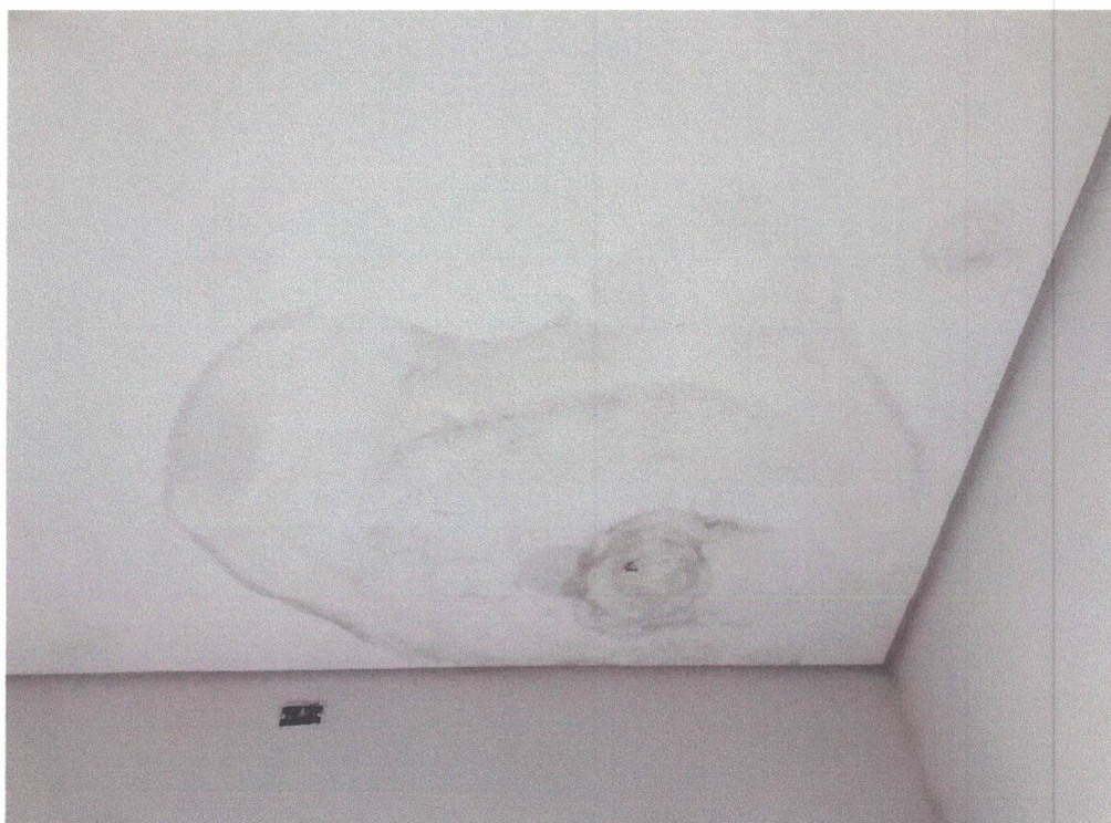
Imagem 17: infiltração do forro do quarto.
