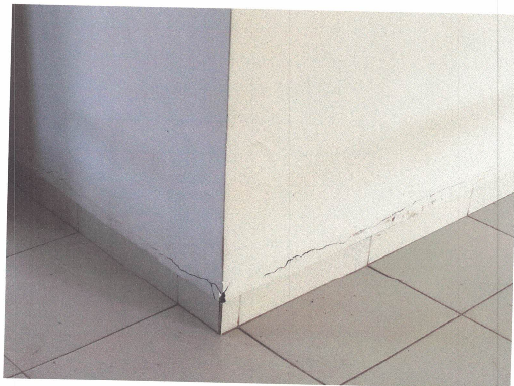
Imagem 54: parede da cozinha – trinca na base da parede.
