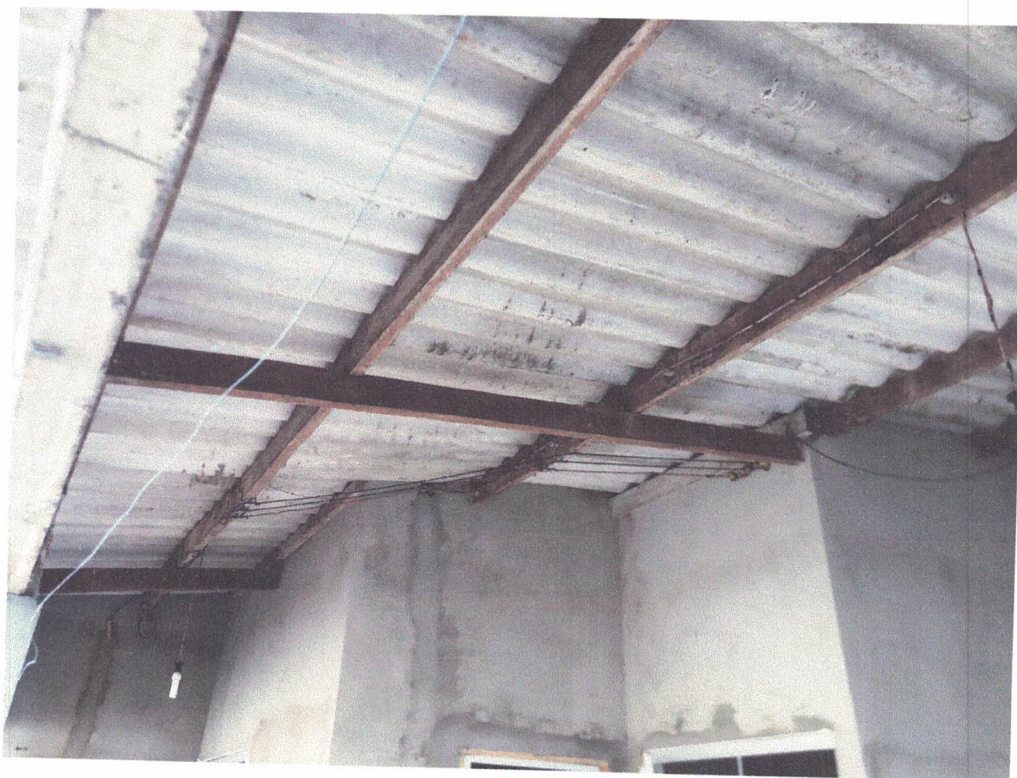
Imagem 69: telhado da varanda – fiações expostas.
