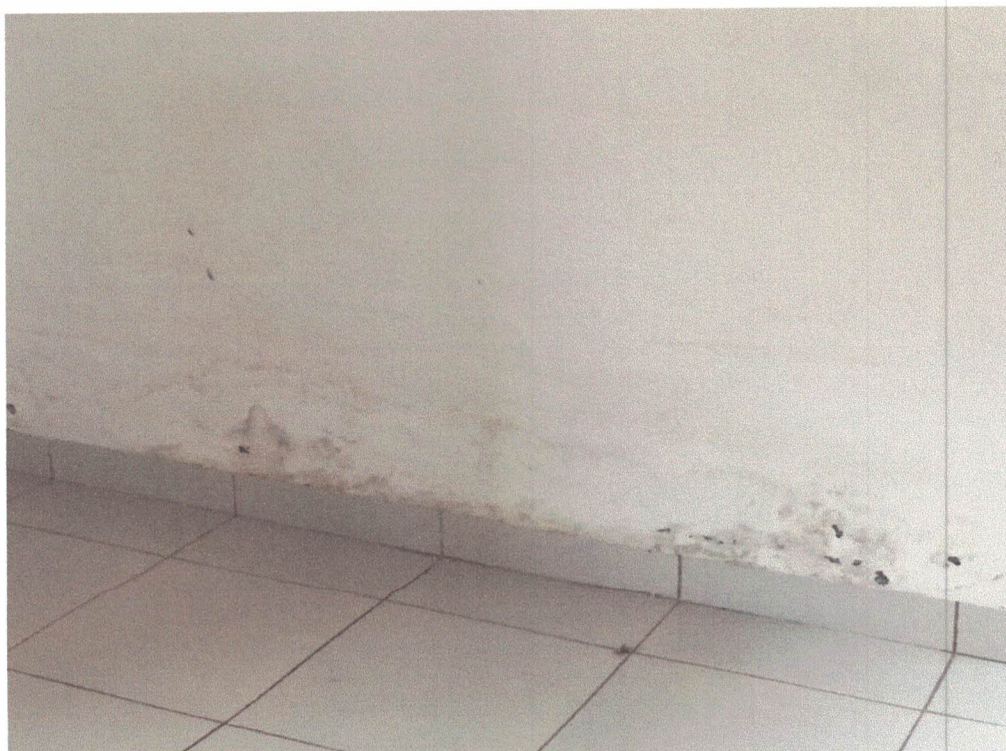
Imagem 37: infiltração na parede.
