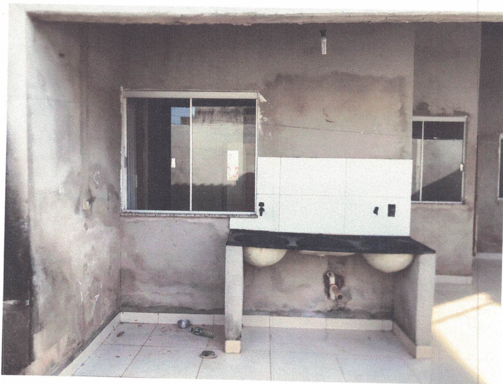
Imagem 64: área de serviço – instalações da tubulação de esgoto do tanque incompleta.
