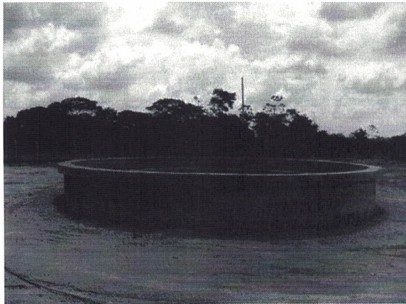
Figura 58: Vista do decantador da ETE.
