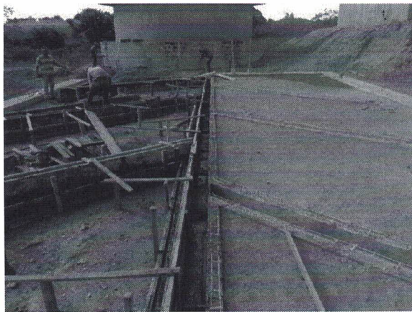
Figura 65: Canaletas do Leito de Secagem.
