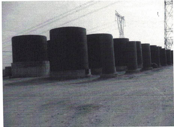
Figura 08: Vista da estrutura dos filtros (FAP e FRD) da ETA.
