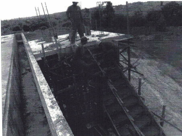
Figura 72: Escada de acesso ao Reator Anaeróbio.
