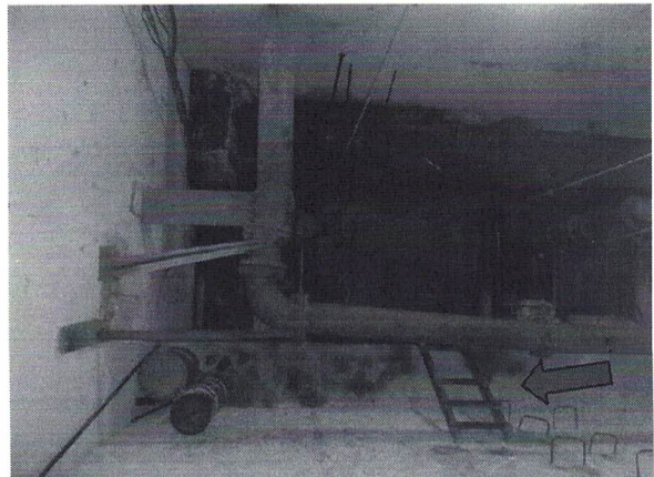
Figura 32: Conjunto motor-bomba e improviso de acesso "escada". Fonte: COSANPA (2015).
