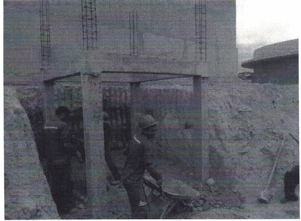
Figura 71: Estrutura da caixa divisória de vazão do Reator Anaeróbio.
