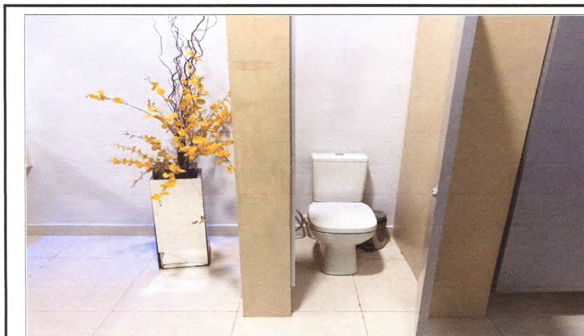
Foto 08: Louças sanitárias do banheiro comum 02.
