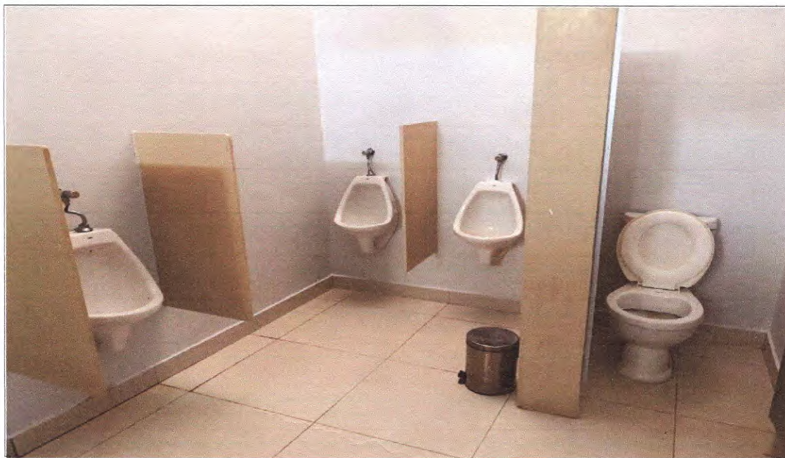
Foto 06: Louças sanitárias do banheiro comum 01.
