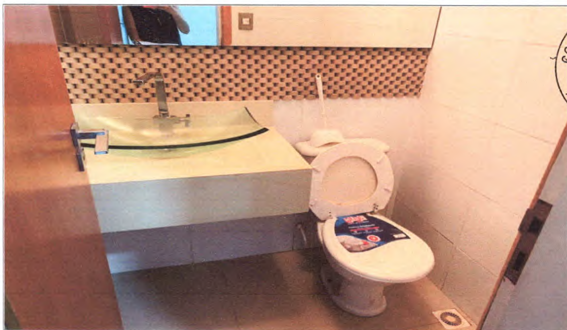
Foto 13: Louças sanitárias do banheiro comum 03.
