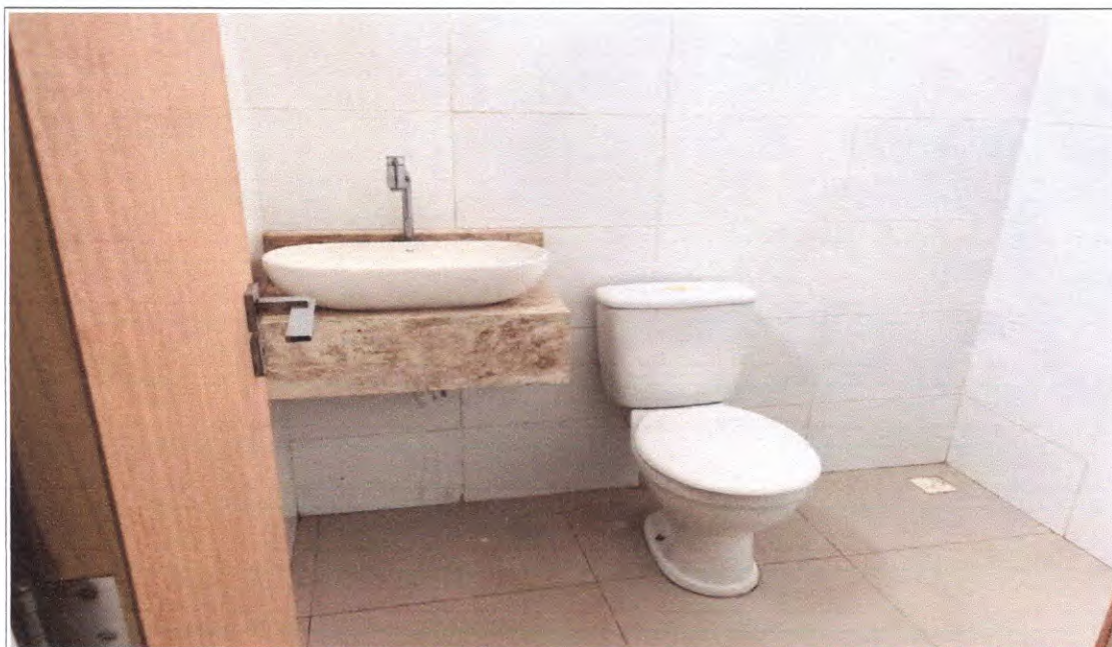
Foto 24: Louças sanitárias do banheiro comum 04.
