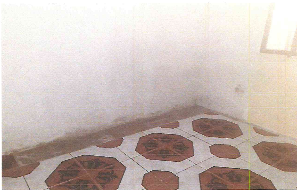
FOTO 08: QUARTOS – PISO CERÂMICO (DANIFICADO).
