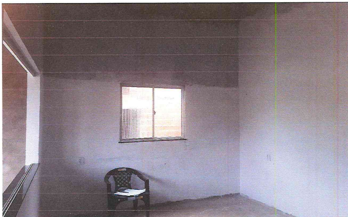
FOTO 02: SALA – PISO CIMENTADO / PAREDE SEM PINTURA.
