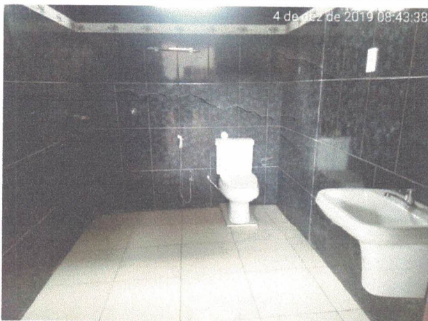
Banheiro PNE – Faltando barras
