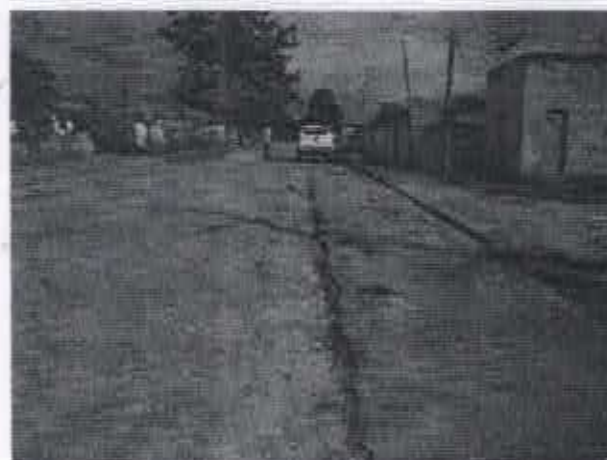
Foto 3.0 - Avenida Anchieta apresentando rasgos que não foram corrigidos
