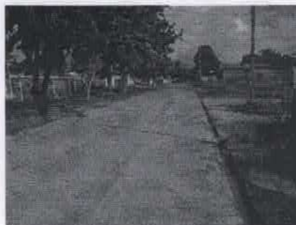
Foto 4.0 - Avenida Anchieta apresentando rasgos que não foram corrigidos
