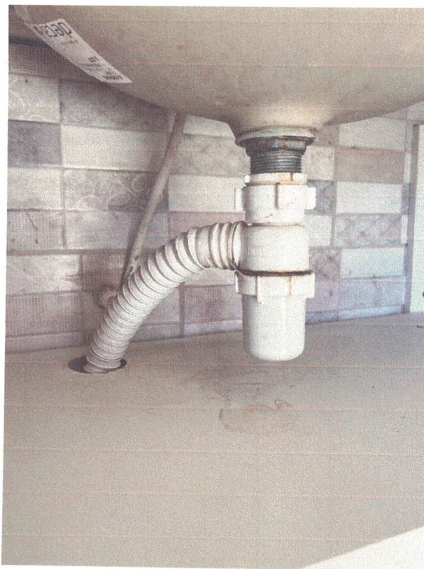
Imagem 39: Sifão do lavatório (sinais de vazamento).
