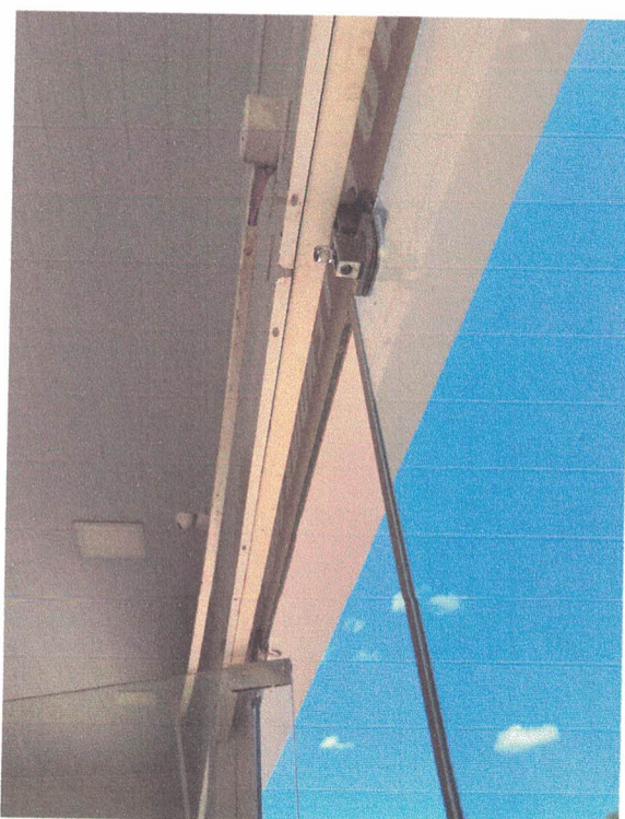
Imagem 17: tranca de pressão superior da porta de acesso à edificação pela Rua Gorotire.
