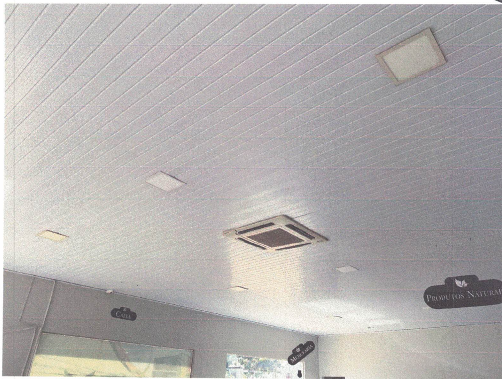
Imagem 25: Split de teto no forro e luminárias tipo plafon led.
