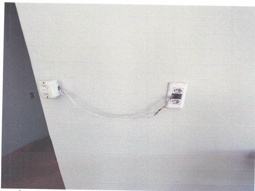
Imagem 35: Salão principal – tomadas instaladas inadequadamente.
