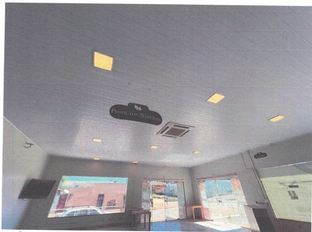
Imagem 26: Iluminação funcionando no salão principal da edificação.
