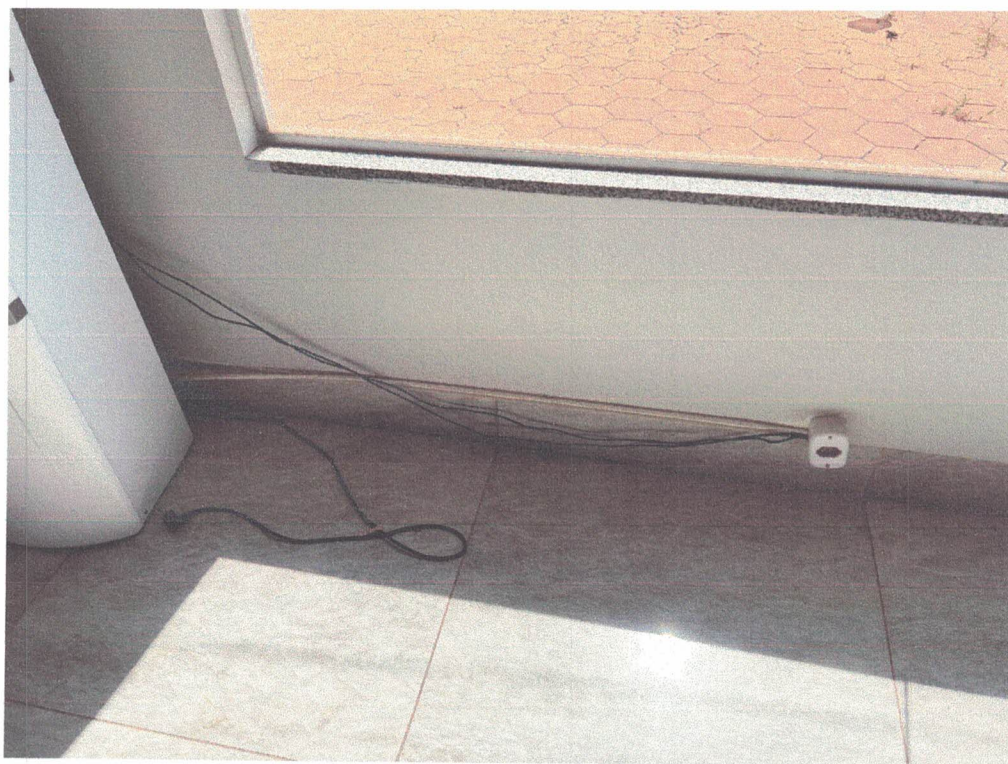
Imagem 31: Salão principal – fiação exposta.
