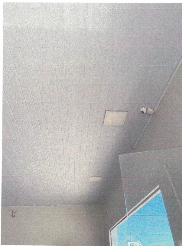
Imagem 23: câmera de Segurança no teto e forro em PVC.
