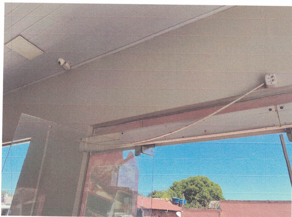
Imagem 32: Salão principal – canaletas que abrigam fiação mal instalada.
