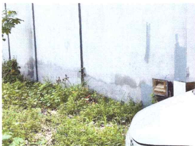
Figura 19: Infiltração na lateral esquerda
