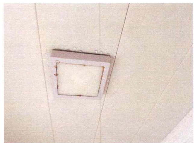
Figura 6: Luminária com infiltração.
