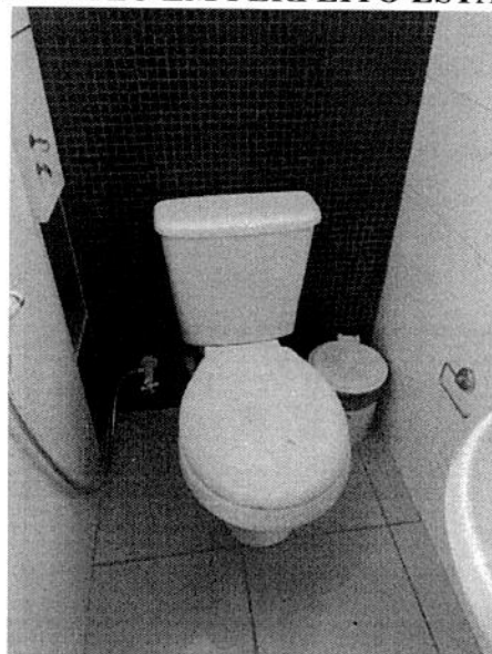
FIGURA 21 – VASO SANITÁRIO EM PERFEITO ESTADO DE CONSERVAÇÃO
