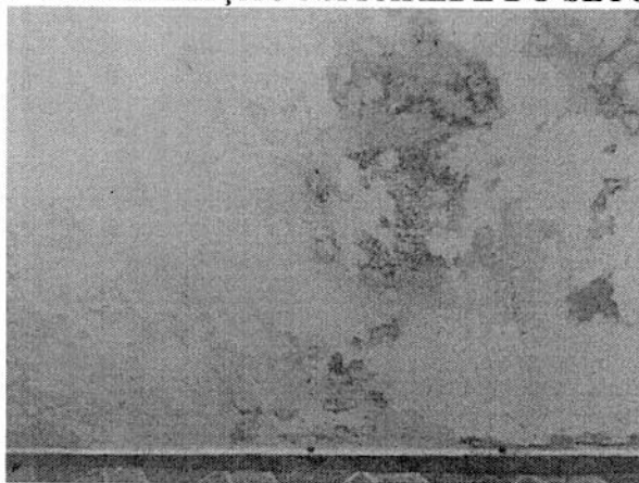
FIGURA 24 – INFILTRAÇÃO NA PAREDE DO SETOR ANEXO
