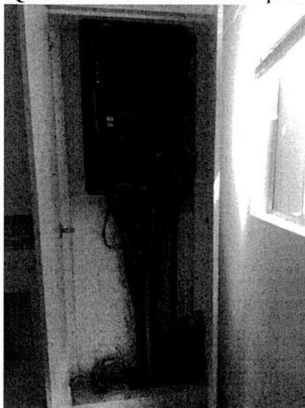
FIGURA 8 – QUADRO DE DISTRIBUIÇÃO ELÉTRICA
