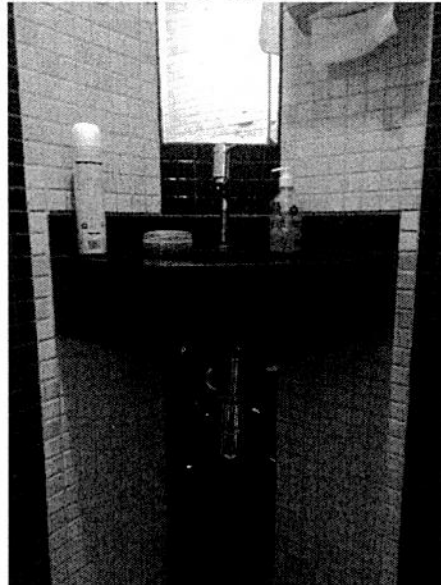
FIGURA 11- PIA EM PERFEITO ESTADO DE FUNCIONAMENTO
