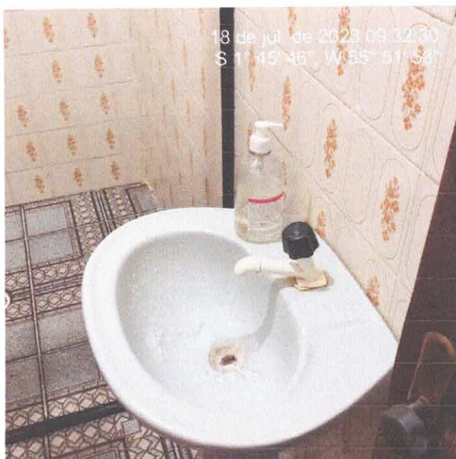
Figura 7 – pontos de água fria.
