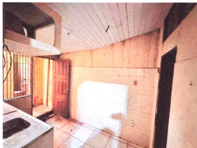
Figura 27: Área de serviço em mal estado
