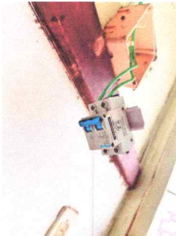
Figura 12: Precisa de reparo
