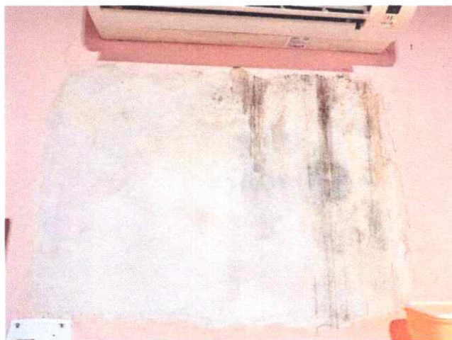
Figura 23: Precisa de reparos na pintura
