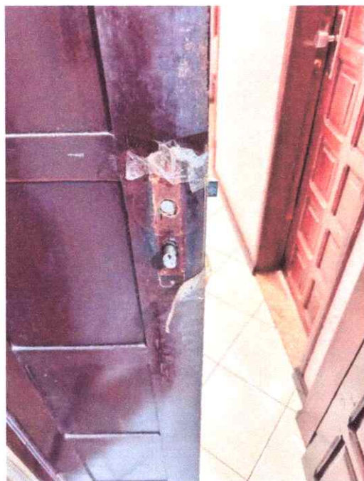
Figura 5: Porta precisa de fechadura
