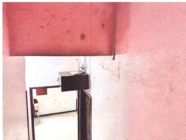
Figura 24: Pintura em mau estado
