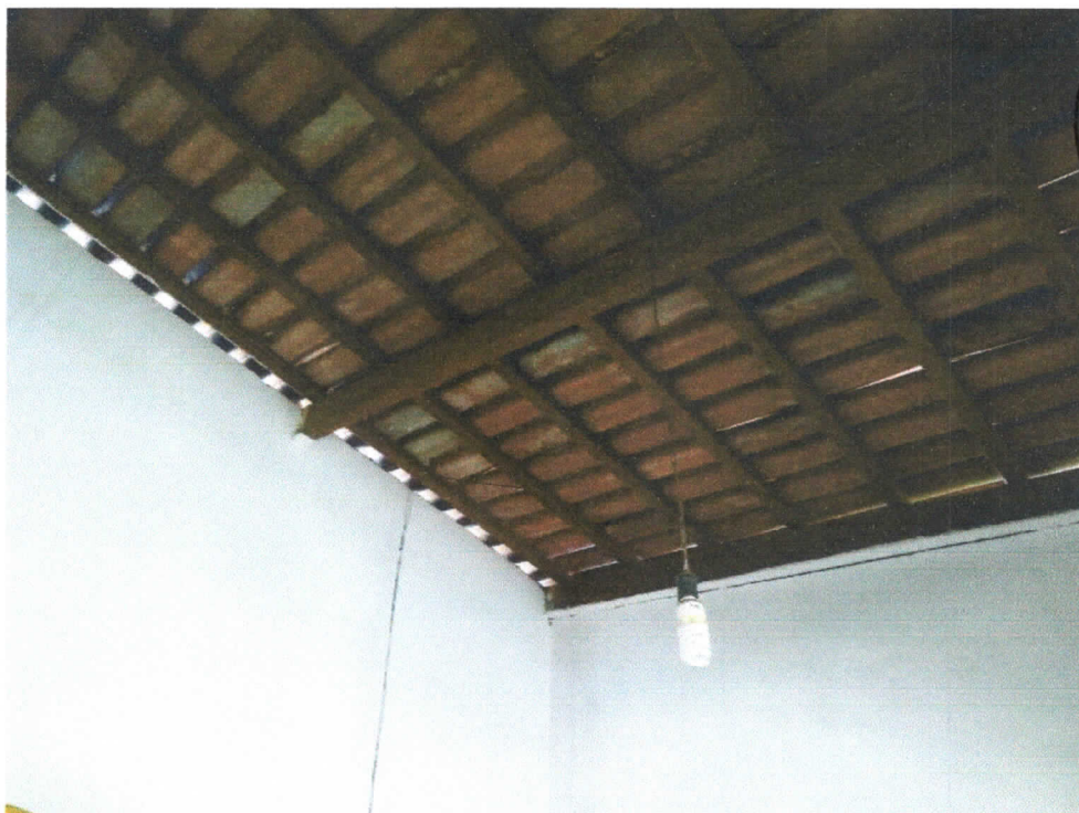
Foto 6 – Telhado Cozinha (necessidade de forro)
