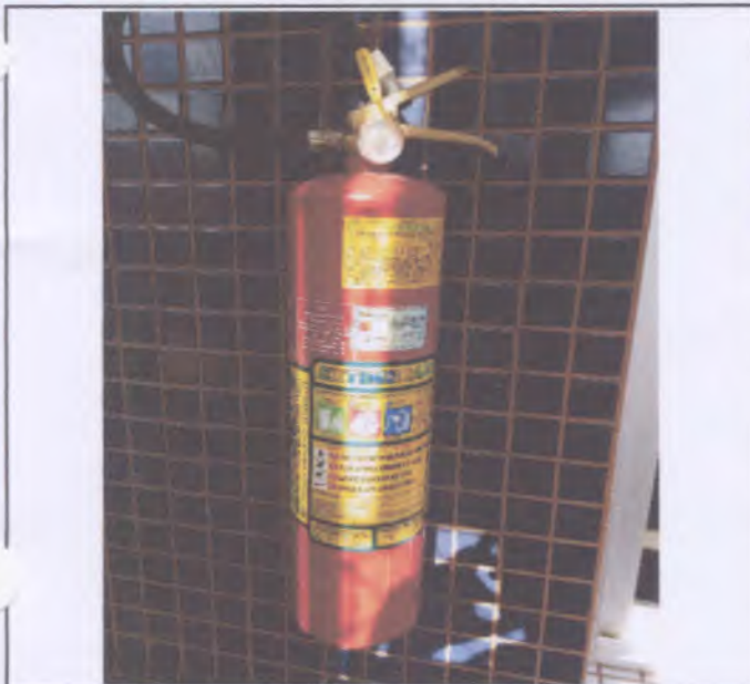
Foto 15: Extintor de incêndio instalado
