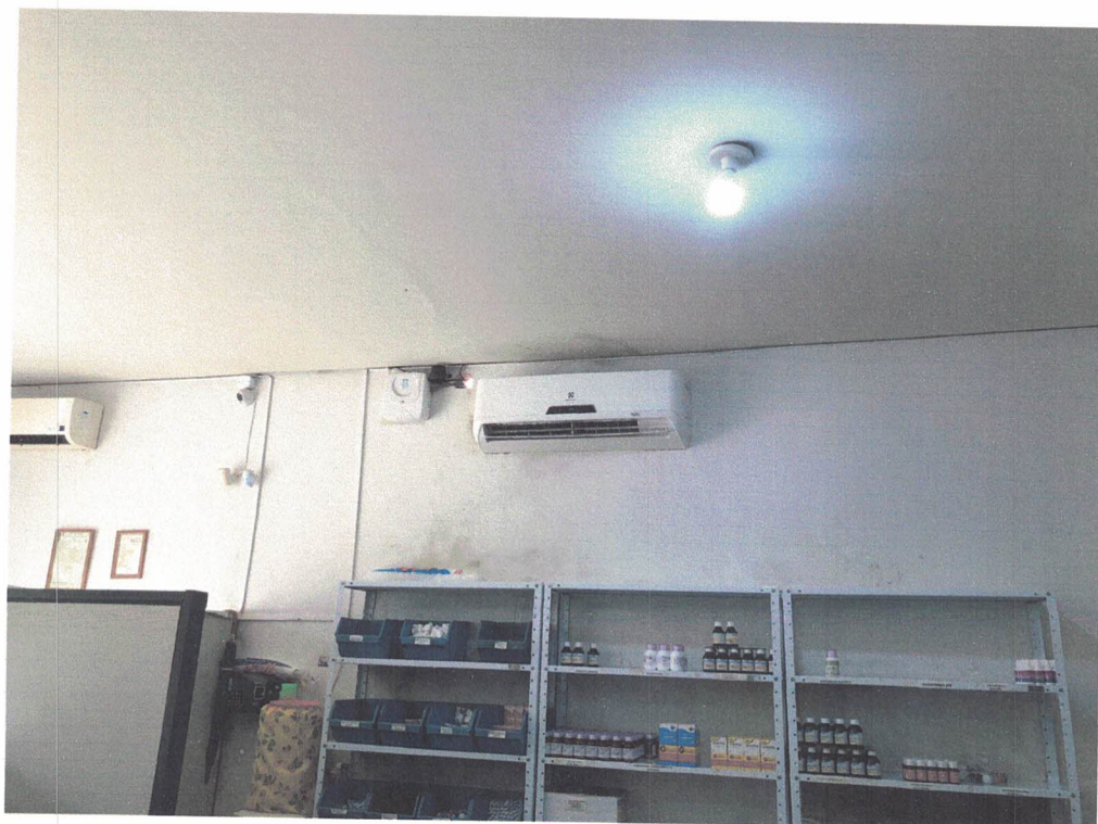
Imagens 14 e 15: equipamentos instalados no interior da edificação.
