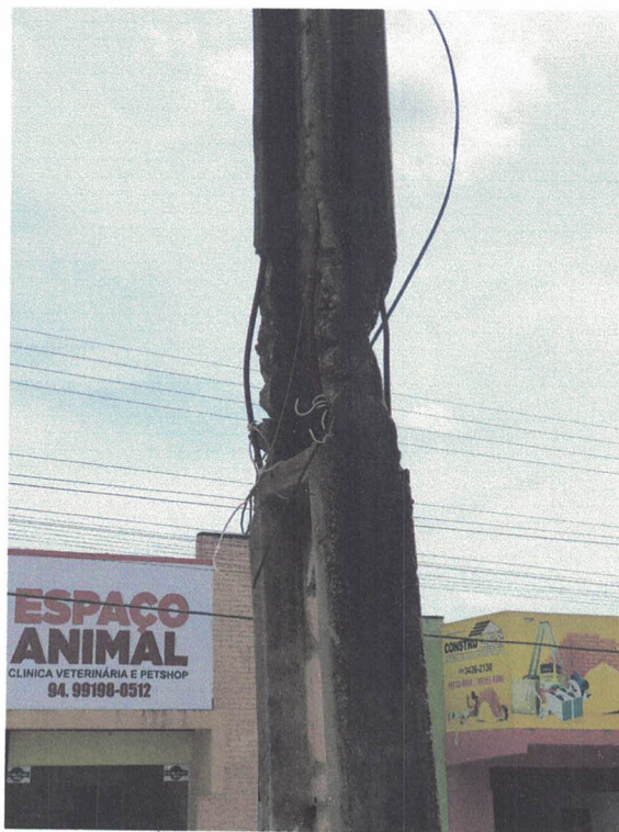
Imagem 31: ângulo mais detalhado do poste avariado instalado à frente da edificação.
