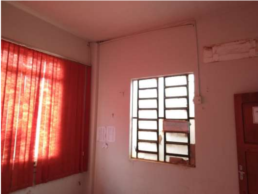
Figura 03 – Janela de vidro danificada, sala 1.
