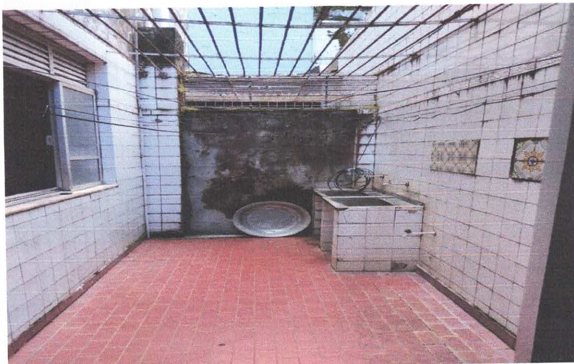
Figura 03; area de serviços, sem cobertura e sem piso antiderrapantes, necessarios alguns reparos.
