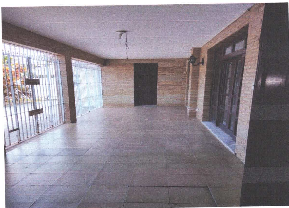
Figura 04; varanda, necessários reparos no piso e verifica ser o piso e antiderrapante, por ser tratar de área externa.
