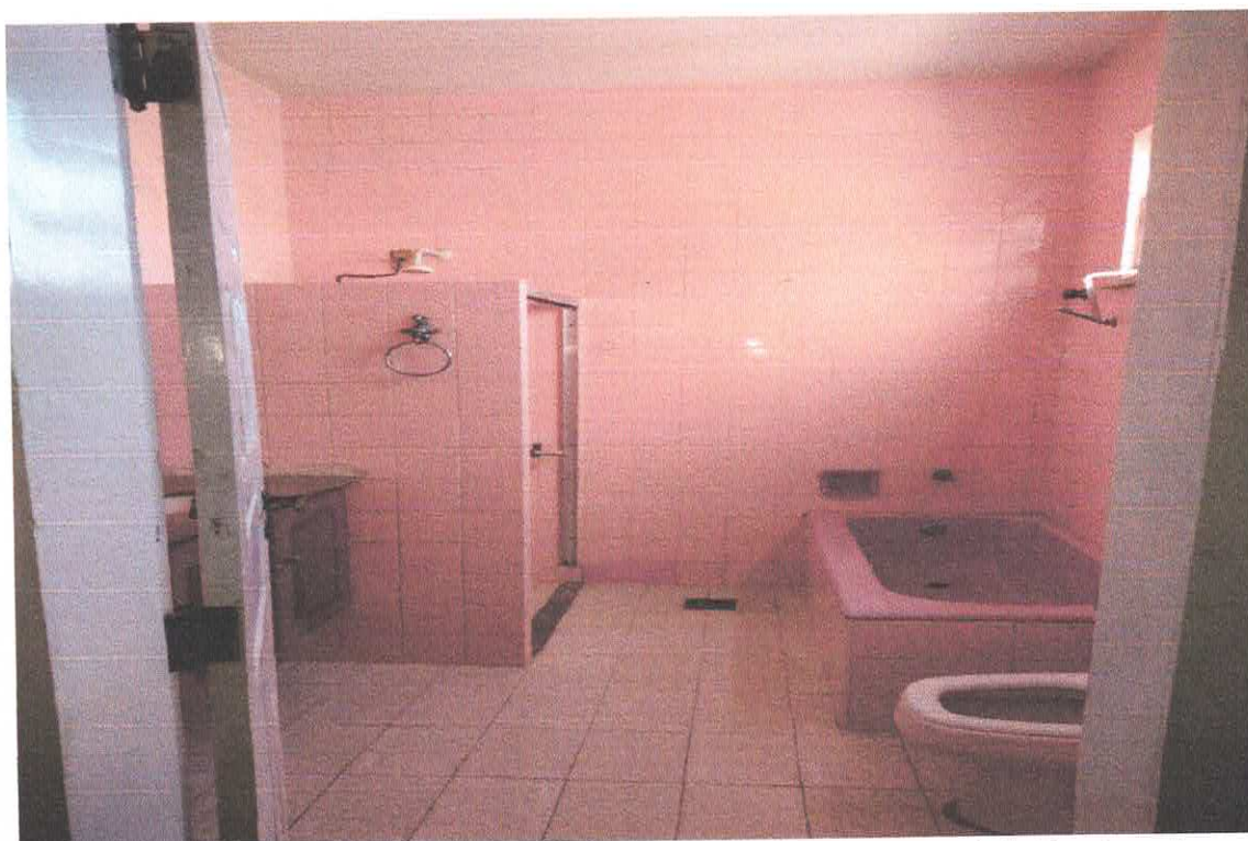
Figura 12; banheiro, necessárias adequações para pessoas deficiências. A instalação de barras de segurança.
