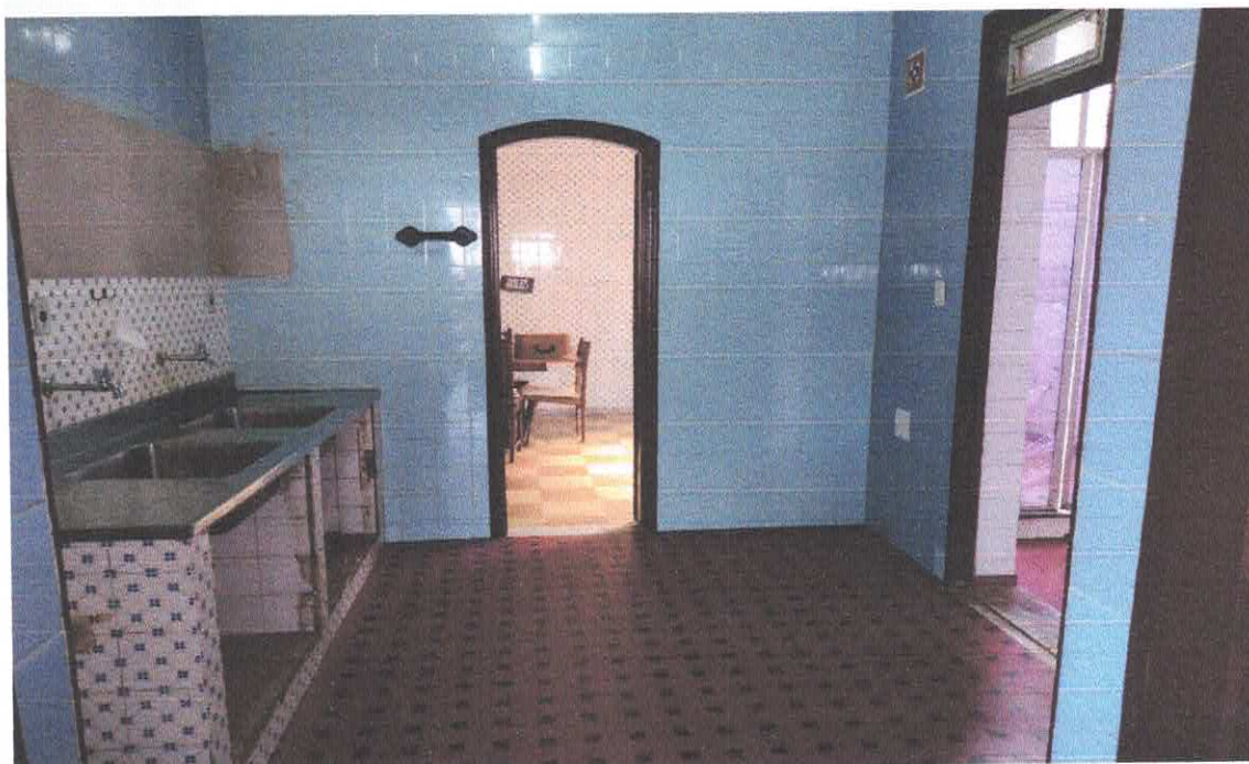
Figura 07; cozinha, necessários alguns reparos.
