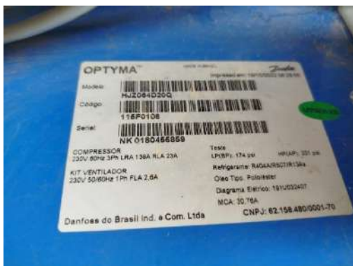
Figura 1: Placa de identificação
