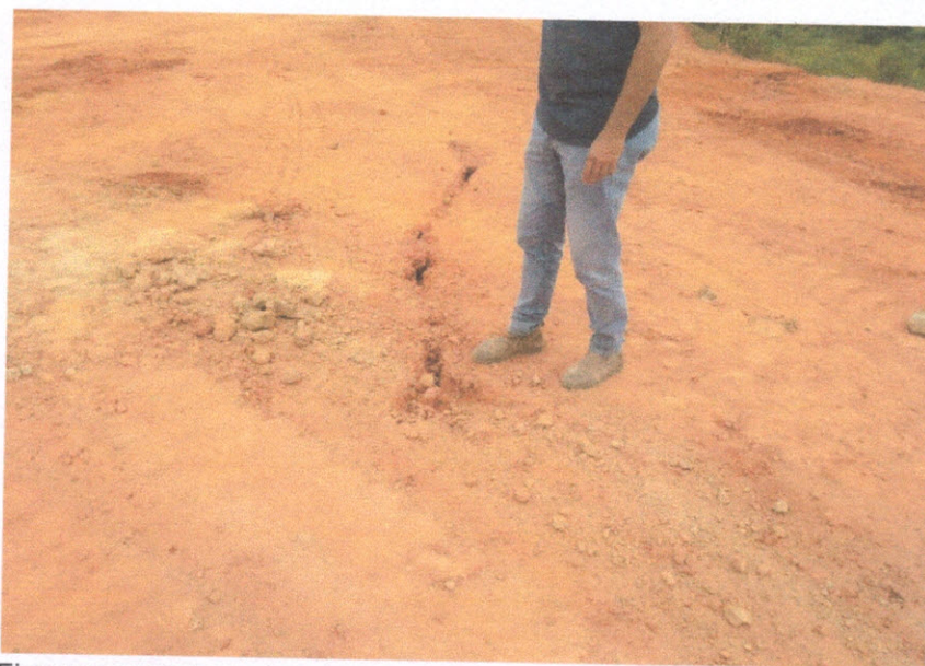
Fissura aparente no terreno ao entorno
