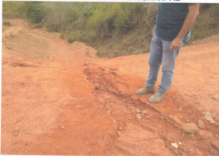
Fissura na encosta
