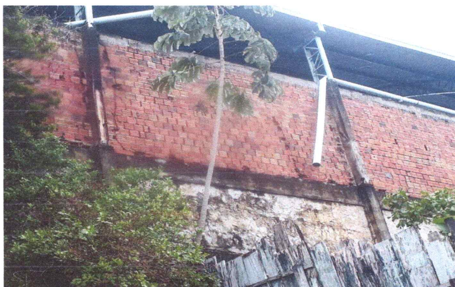
Figura 4 - Área externa - muro de arrimo com rachaduras
