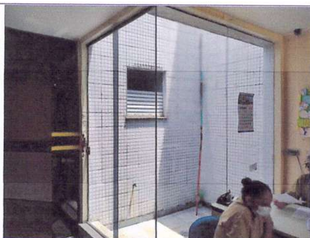
Foto 07: Área de ventilação
