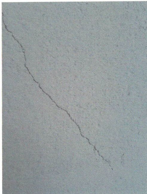
FIGURA 04: Imagem da fissura encontrada na parede rebocada do Apart. 06 do 1º Pavimento.
