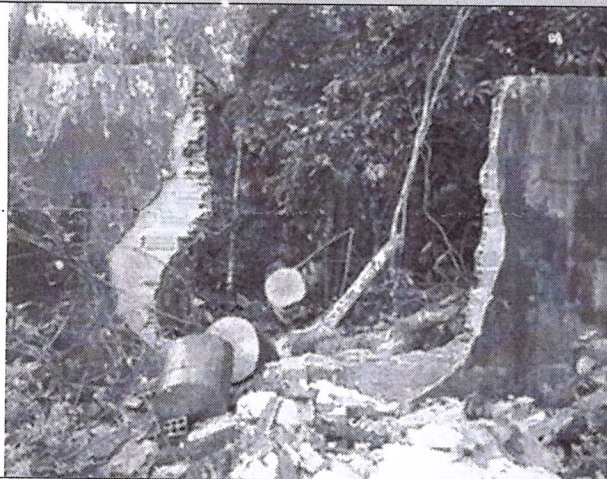
Muros divisórios parcialmente destruídos.
