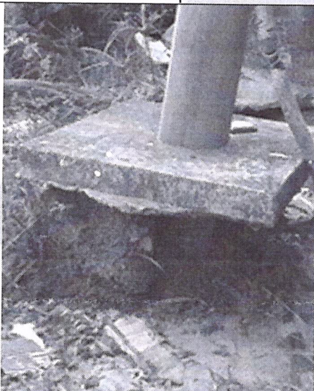
Laje de proteção do poço desestabilizada.
