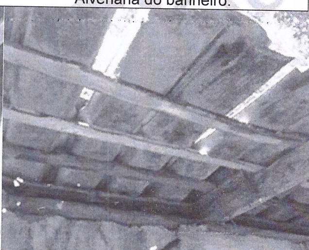
Madeiramento e telhas deterioradas.
