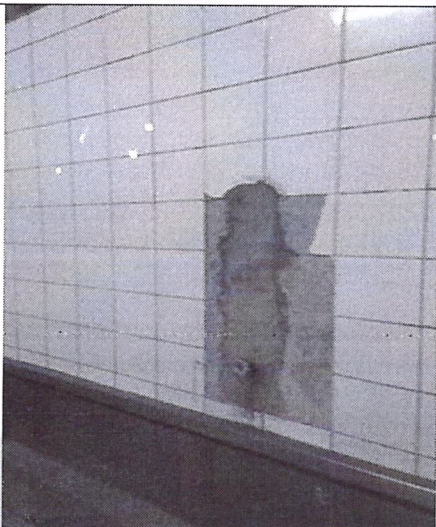
Revestimentos de paredes quebrados.
