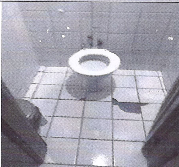
Banheiros com pisos quebrados e vaso sem assento sanitário.
