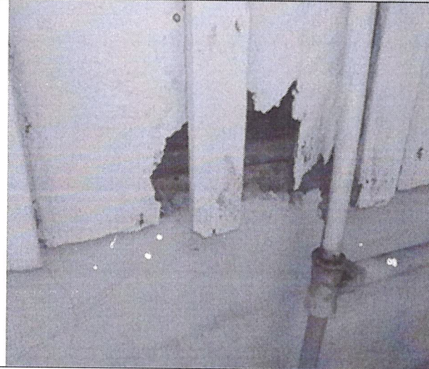
Paredes de madeira deterioradas.
