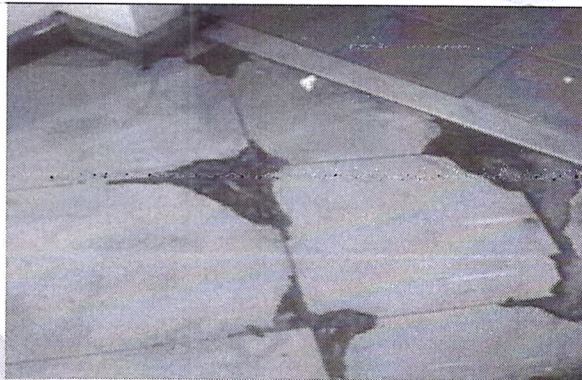
Pisos vinílicos deteriorados.
