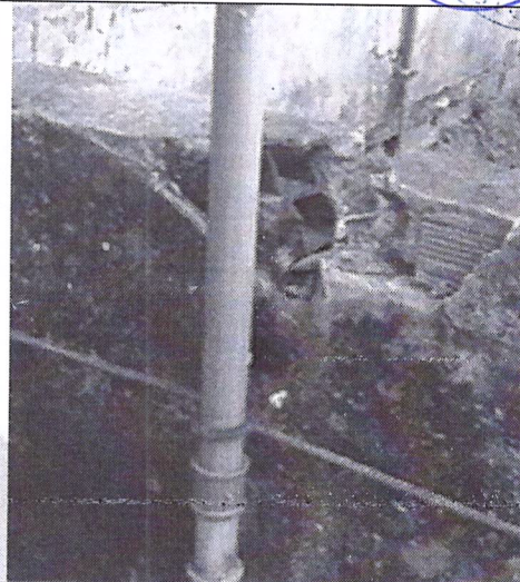
Mureta de alvenaria quebrada.
