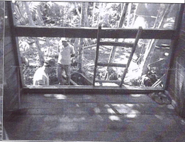
Ausência de guarda corpo de proteção.
