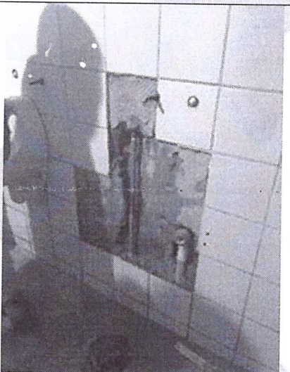
Falta de mictório, caixa sifonada destruída, revestimento cerâmico arrancado e tubulação exposta.
