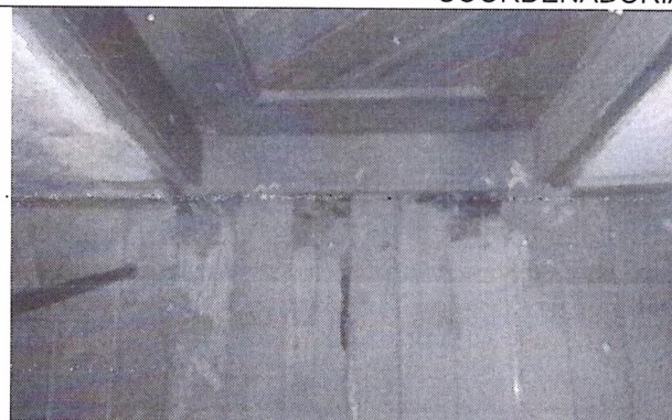
Assoalhos de madeira deteriorados.
