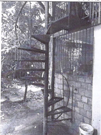
Escada de acesso ao segundo nível de depósito sem condições de uso.
