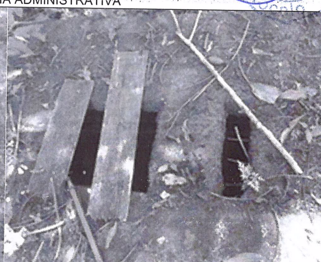
Fossa fora de padrão e sem tampa.
