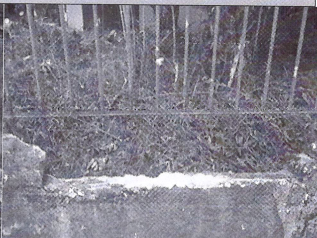
Muro frontal parcialmente destruído e grades soltas e danificadas.
