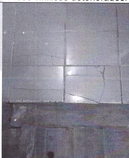
Revestimentos de paredes quebrados.
