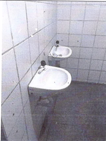
Lavatórios com torneiras danificadas e em número insuficiente.
