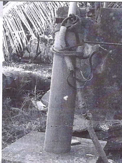
Instalação elétrica do poço fora de padrão.
