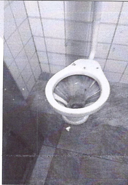
Louças sanitárias danificadas, sem assento, boxes sem portas.
