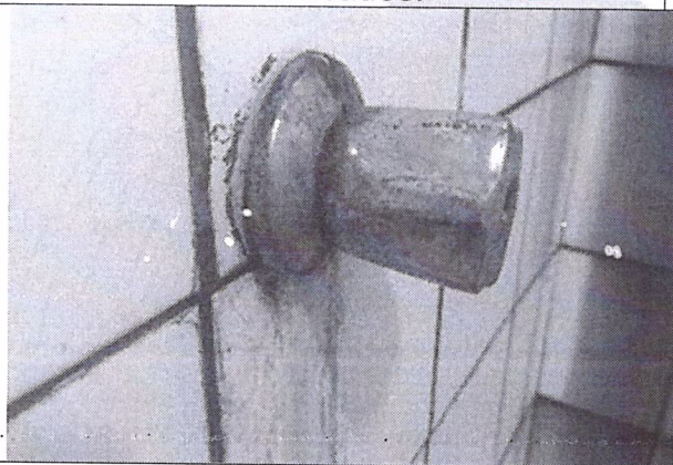
Registros de pressão com vazamento.
