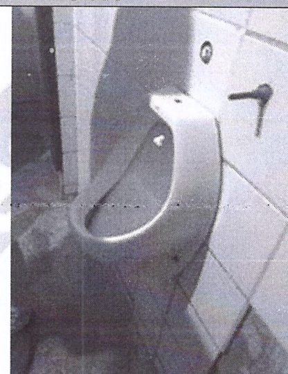
Mictório sem engate, sem sifão e registro sem comando.
