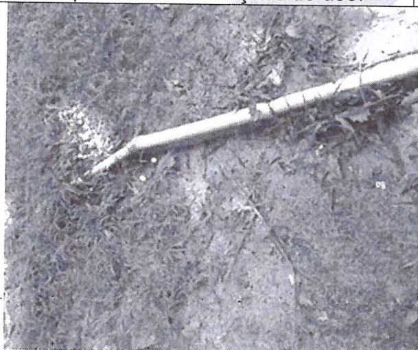
Tubulação de esgoto aparente, quebrada e caixa de gordura inexistente.
