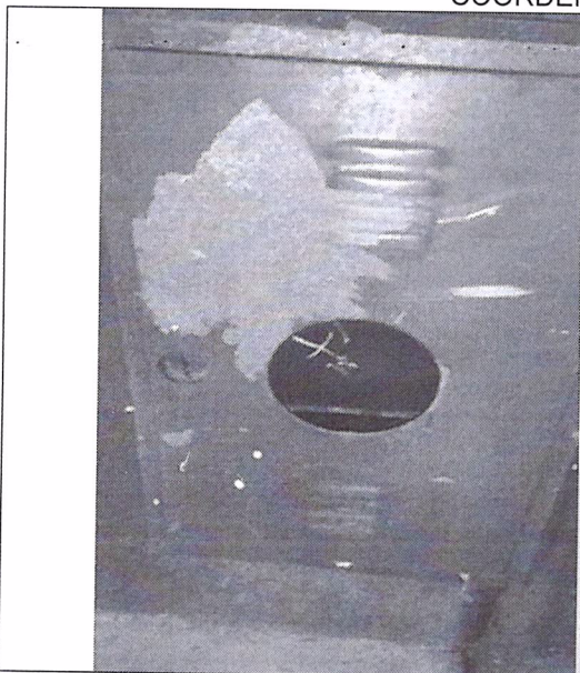
Caixas de hidrantes sem conservação e sem as mangueiras.
