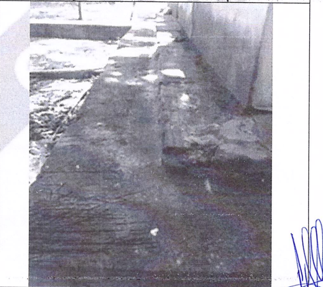
Passeio externo destruído.
