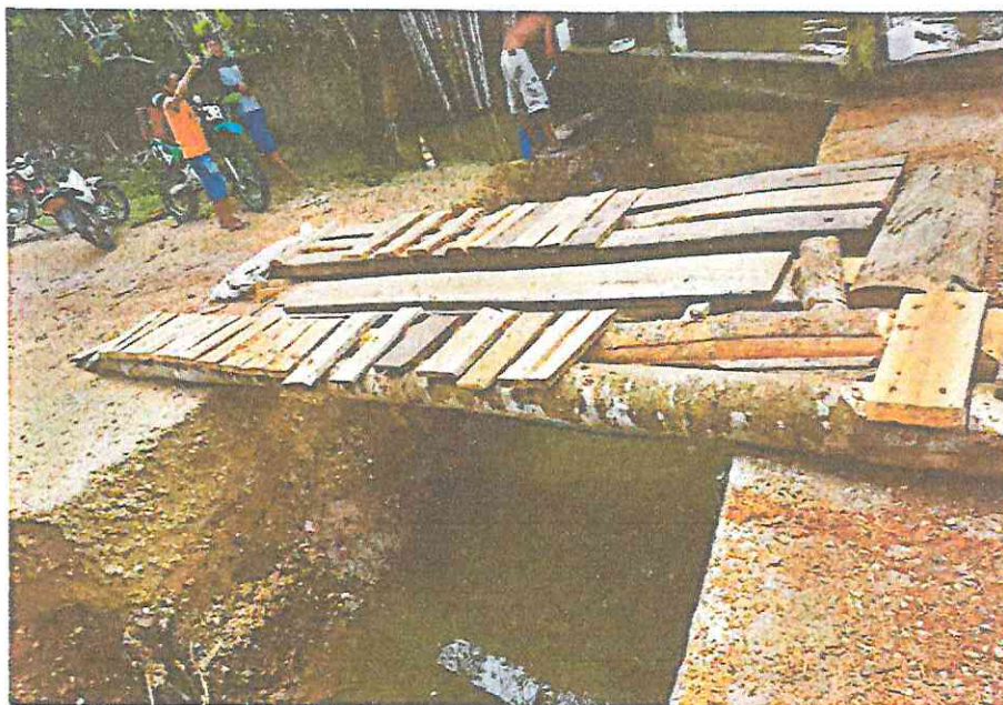
Ponte improvisada por conta dos estragos das chuvas intensas
