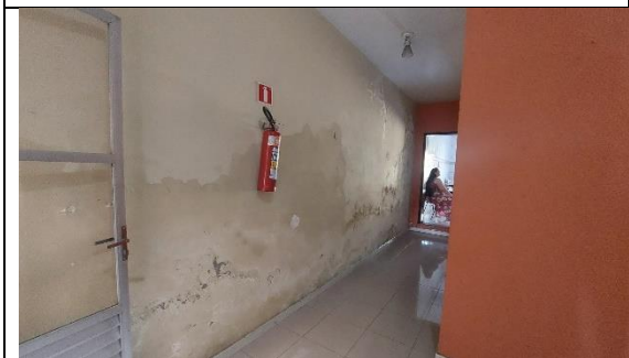
Foto 5: parede com umidade
