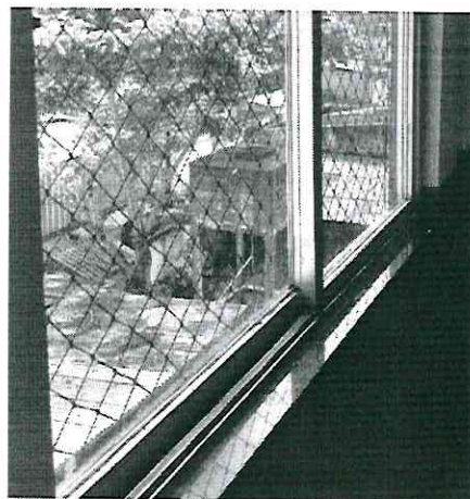
Foto 07- Vidro trincado na janela do refeitório.
