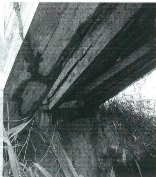
Vista de uma das peças danificadas na parte inferior da ponte e apresentado problema.
