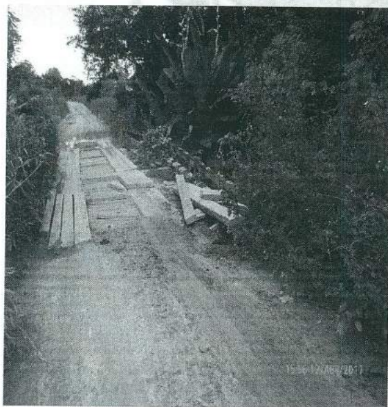
Vista da ponte em risco de desabamento.
