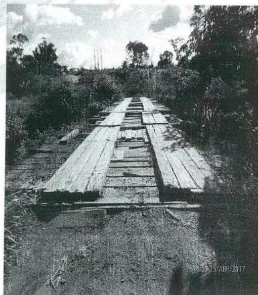
Vista da ponte em risco de desabamento.
