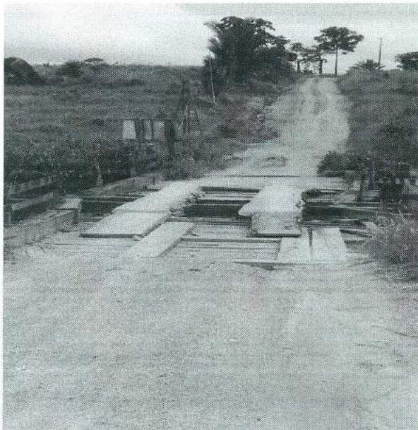
Vista da ponte de madeira com situação crítica.
