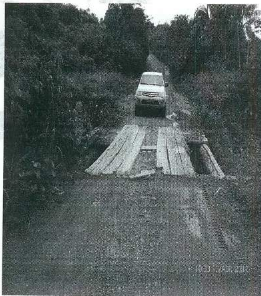
Vista da ponte em risco de desabamento.
