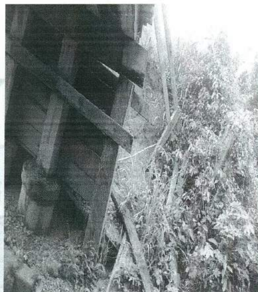
Vista da parte da ponte onde ocorreu desmoronamento de terra arrastado pelo rio.
