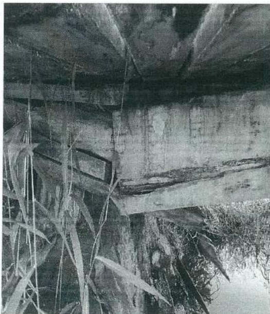
Vista da ponte de madeira com situação crítica.
