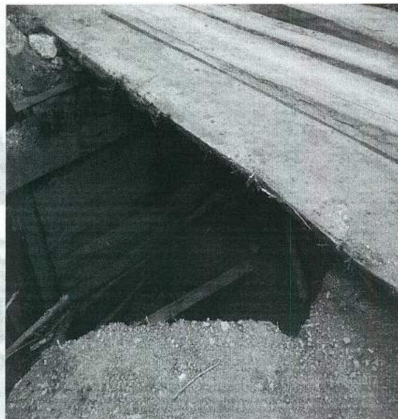
Vista da colocação de pranchão, devido o desmoronamento de terra arrastado pelo rio.
