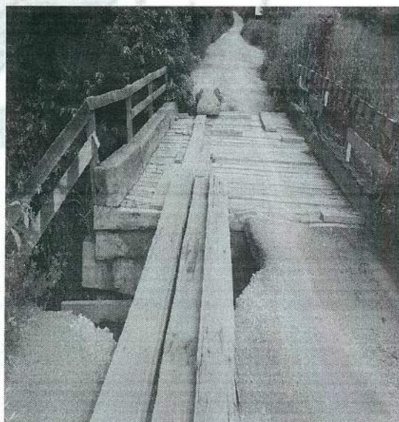
Vista da ponte em risco de desabamento.
