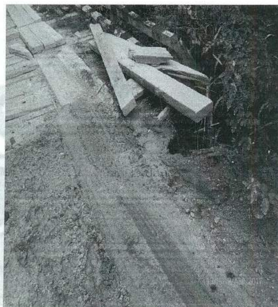
Vista de uma das partes da ponte apresentado problema.
