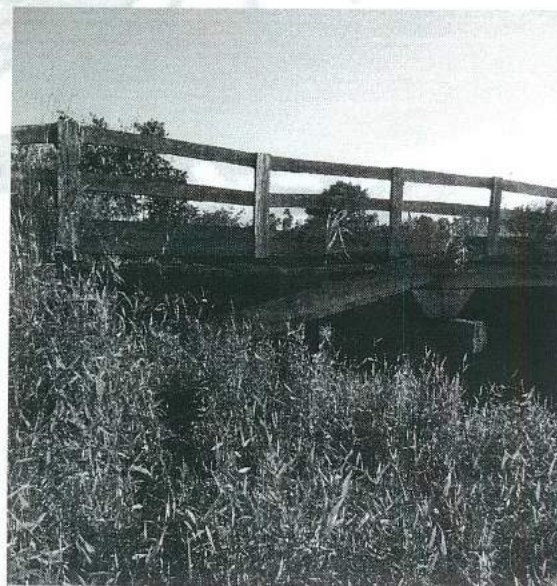
Vista da ponte em risco de desabamento.
