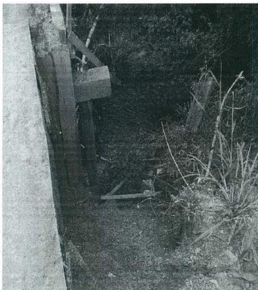
Vista da ponte de madeira com situação crítica.
