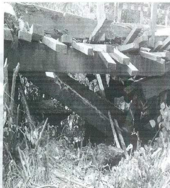
Vista da ponte pela lateral, peças de madeira danificadas.
