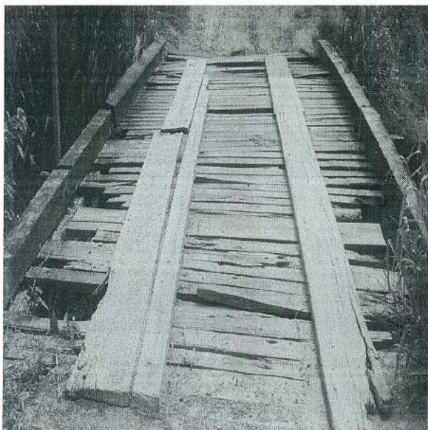
Vista da ponte de madeira com situação crítica.
