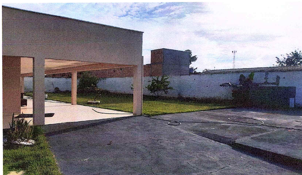
Figura 07 – Acessos Internos com necessidade de reparos.
