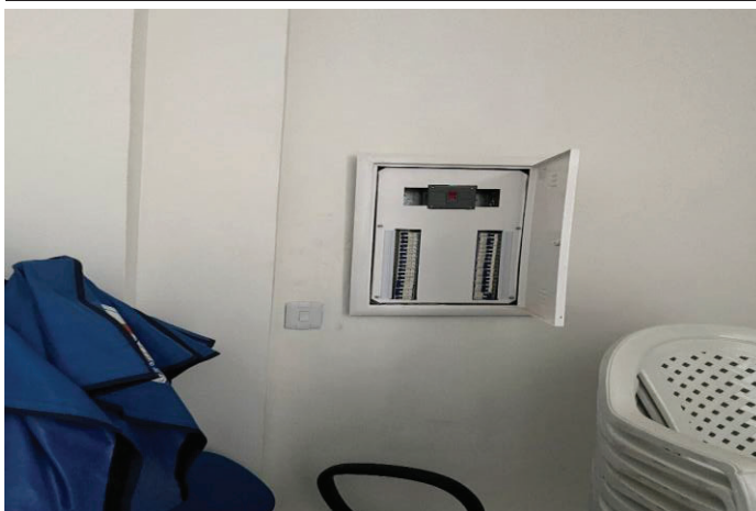
quadro de distribuição elétrico
