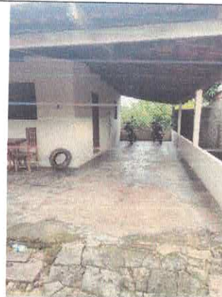
Figura 2 - Vista Externa - Entrada da Varanda Coberta. A edificação está muito danificada pelos agentes naturais, apresentando piso rachado, infiltração no telhado. Porém ela é feita de alvenaria, está rebocada e pintada.
