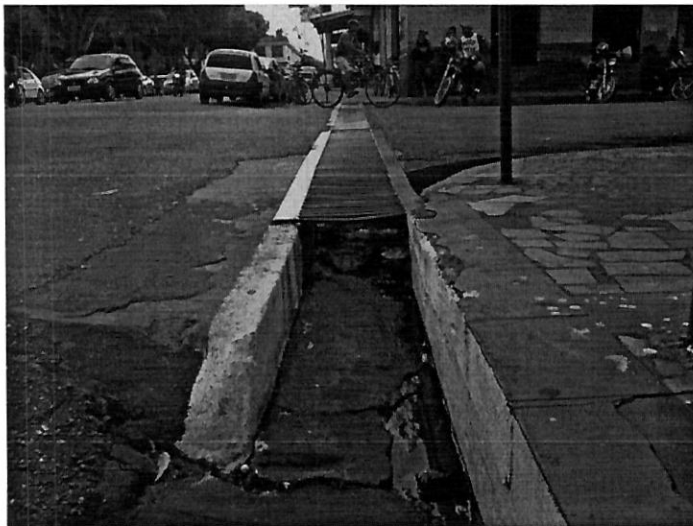
Imagem Ilustrativa – Canaleta metálica no Município
