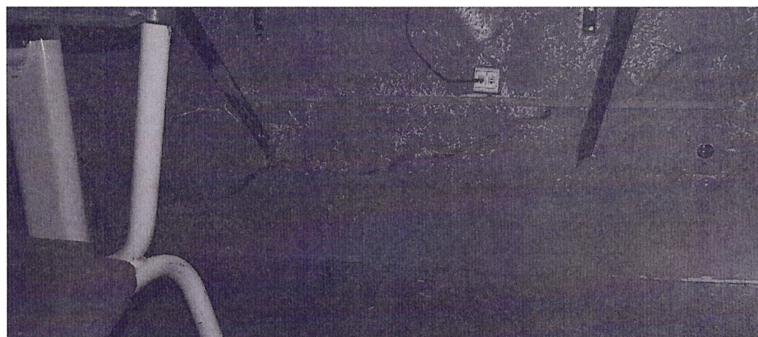
FIGURA 5 – TRINCAS OBSERVADAS EM ELEMENTOS DE VEDAÇÃO.
