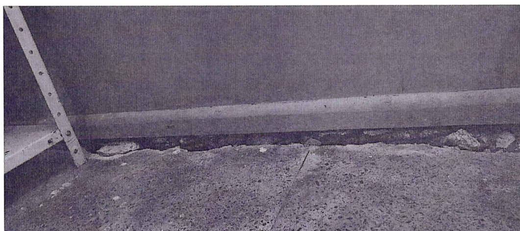
FIGURA 6 – AFUNDAMENTO DO PISO EM RELAÇÃO AO NÍVEL DA ALVENARIA.
