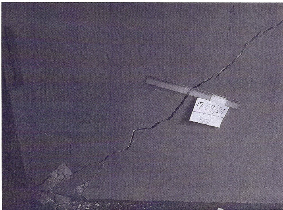
FIGURA 3 – TRINCAS OBSERVADAS EM ELEMENTOS DE VEDAÇÃO.
