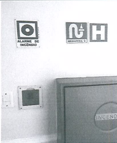
Sistema de combate ao incêndio
