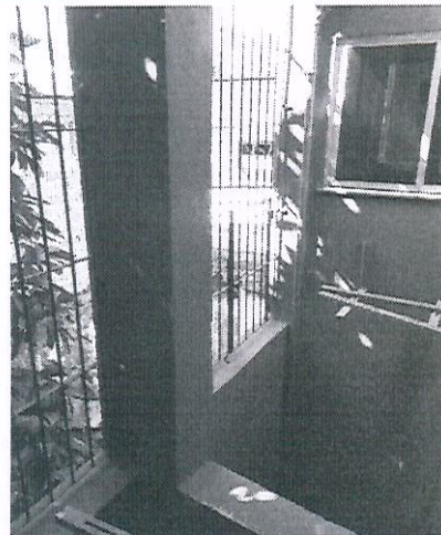
área de ventilação com suporte para Ar Condicionado
