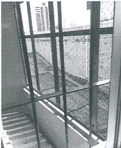
Área de ventilação com grades
