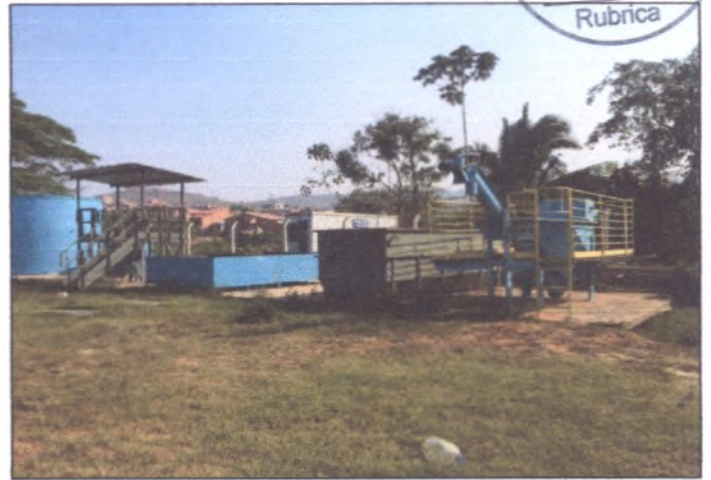
Foto 02 - Filtros, caixa de gordura e desarenador
