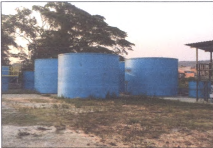
Foto 03 - Reatores biológicos aerados
