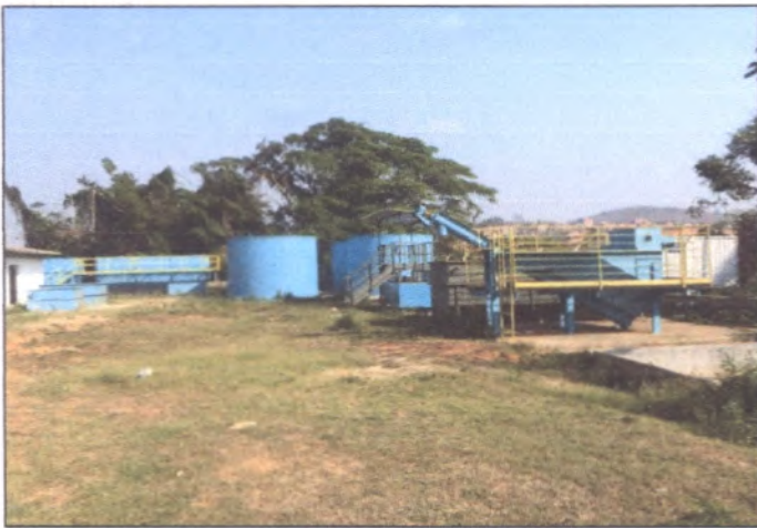
Foto 01 - Visão geral da ETE Vale do Sol
