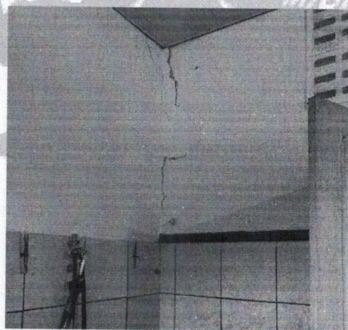
Figura 7 – Vista das rachaduras na parede do depósito.
