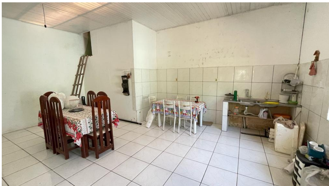
Figura 11 – Cozinha: forro em lambril de pvc, paredes com revestimento cerâmico e pintura, piso com lajota cerâmica, pia em inox de duas cubas, cabeamento elétrico irregular.
