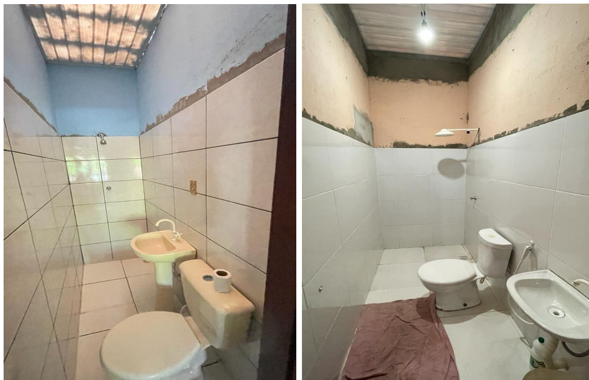
Figura 10 – banheiro com forro em lambril de pvc, paredes com revestimento cerâmico, louças sanitárias adequadas para uso adulto, possui climatização, cabeamento elétrico irregular.
