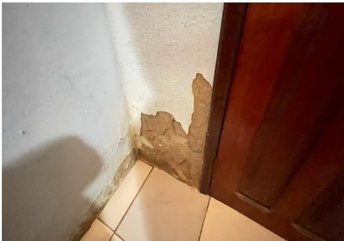
Revestimento de reboco, estourando (suíte)
