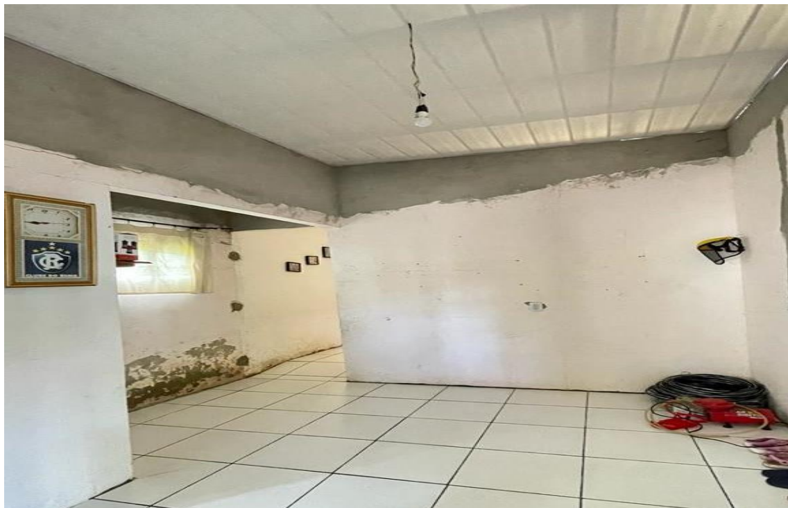
Figura 16 – Sala: com forro em lambril de pvc, paredes com pintura, piso em lajota cerâmica, portas de madeira, janela em madeira, cabeamento elétrico irregular.
