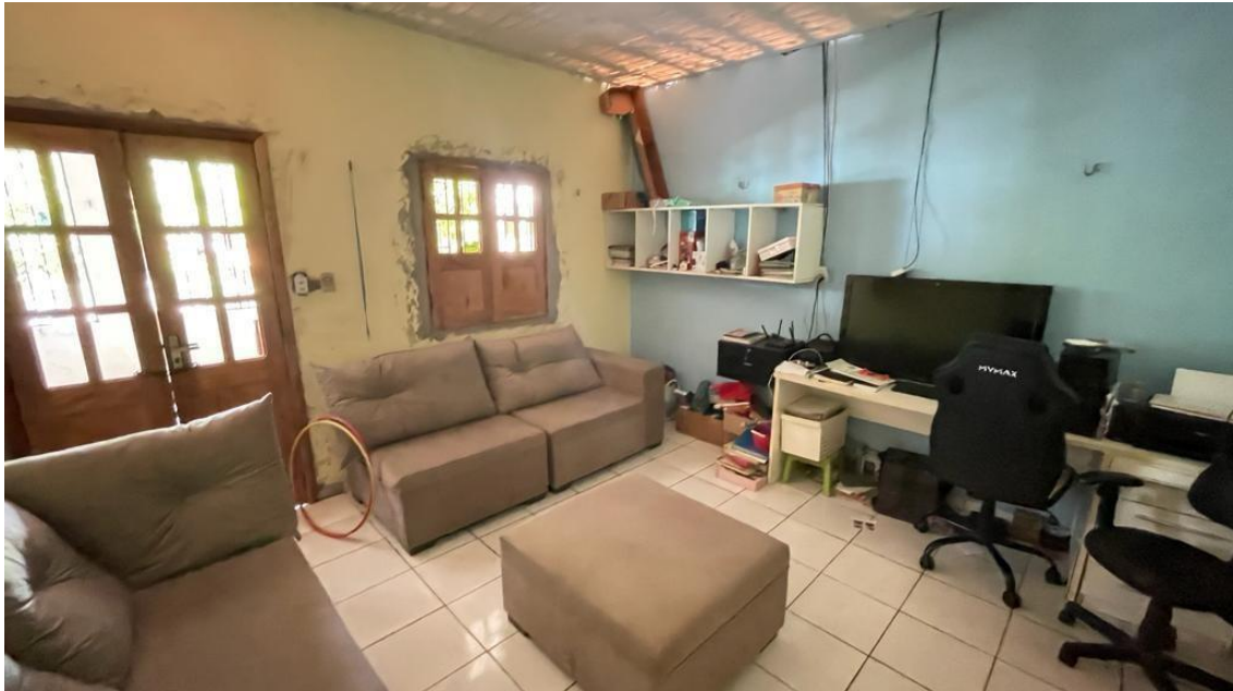
Figura 8 – Sala: com forro em lambril de pvc, paredes com pintura, piso em lajota cerâmica, portas de 02 (duas) folhas de madeira, janela em madeira, cabeamento elétrico irregular.
