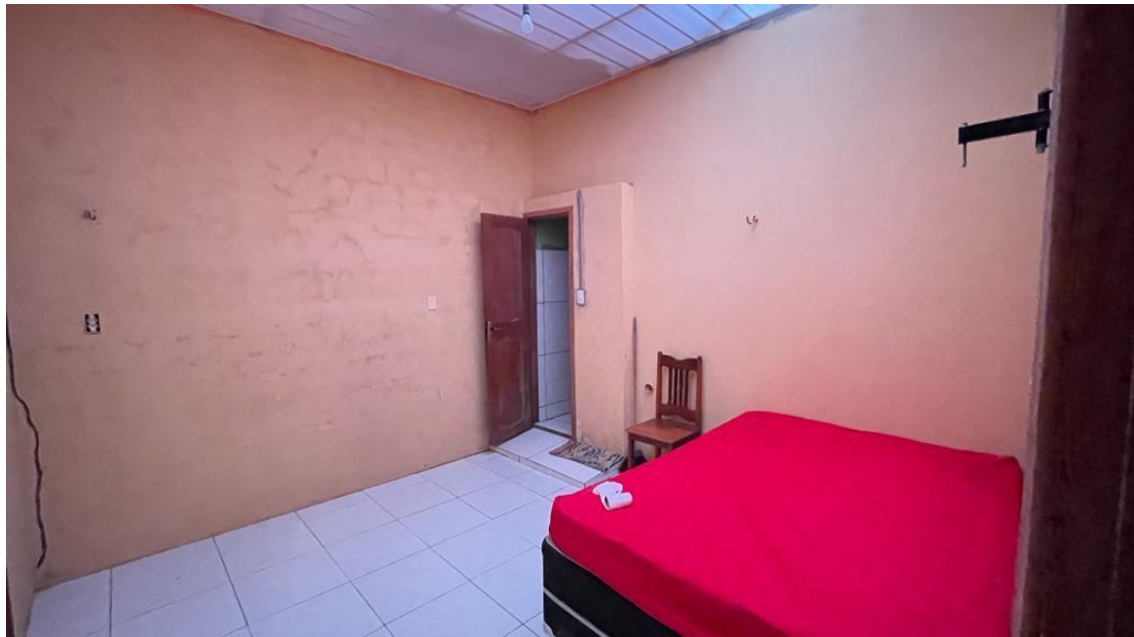
Figura 12 – Quarto: com forro em lambril de pvc, paredes revestidas com reboco, piso em lajota cerâmica, portas em madeira, cabeamento elétrico irregular, presença de cupim.
