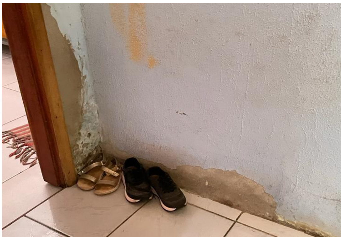
Presença de umidade (suíte)
