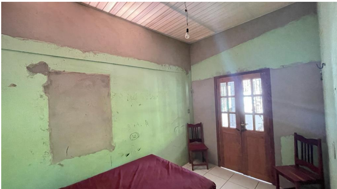
Figura 9 – Quarto: com forro em lambril de pvc, paredes revestidas com reboco, piso em lajota cerâmica, portas de 02 (duas) folhas de madeira, janela em madeira, cabeamento elétrico irregular.
