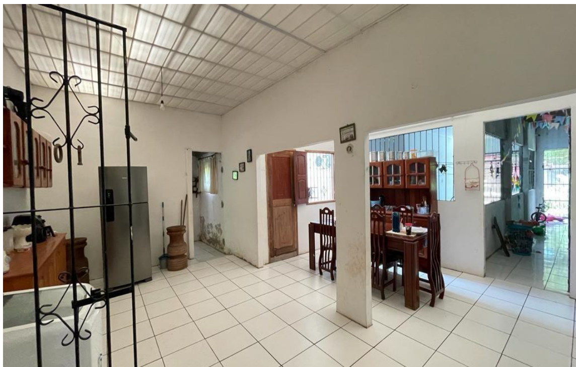
Figura 13 – Cozinha: forro em lambril de pvc, paredes com revestimento cerâmico e pintura, piso com lajota cerâmica, pia em inox de duas cubas, cabeamento elétrico irregular.
