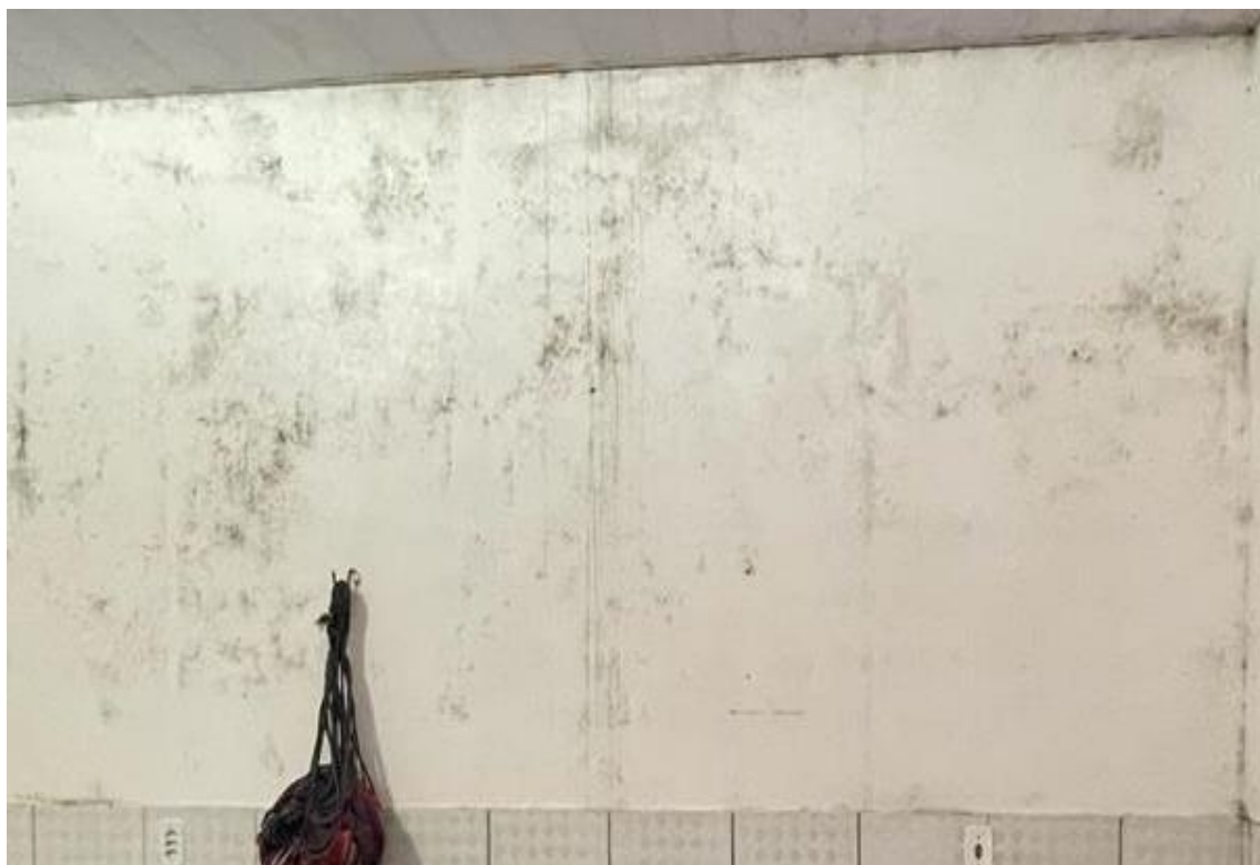
Presença de morfo em parede (suíte)
