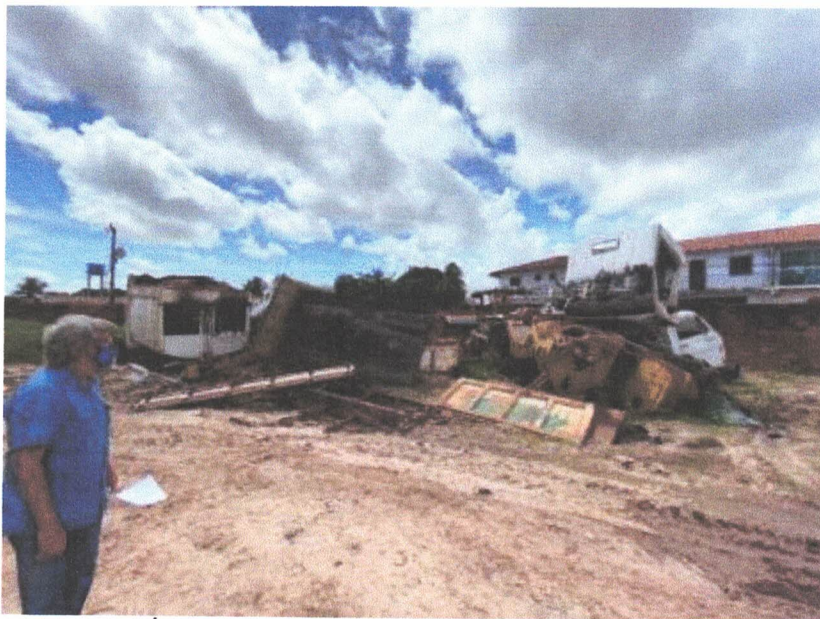
FOTO 10: ÁREA EXTERNA – ENTULHOS PARA FERRO VELHO
