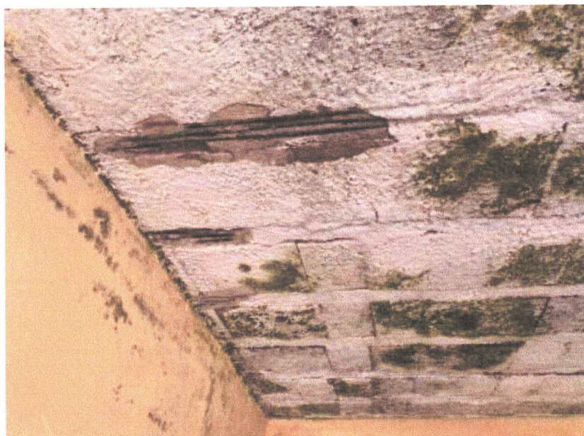
FOTO 06: LAJE PRE MOLDADA COM FERRAGEM DE VIGOTAS APARENTES EM ESTADO DE OXIDAÇÃO
