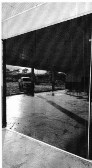
Figura 5 – Vidros precisando de manutenções.
