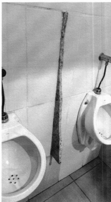
Figura 9 – Vasos encardidos e revestimento de mármore quebrados.
