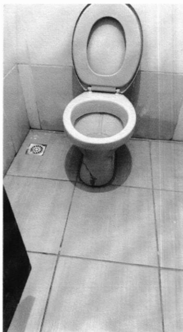
Figura 10 – Vaso sanitário danificado.
