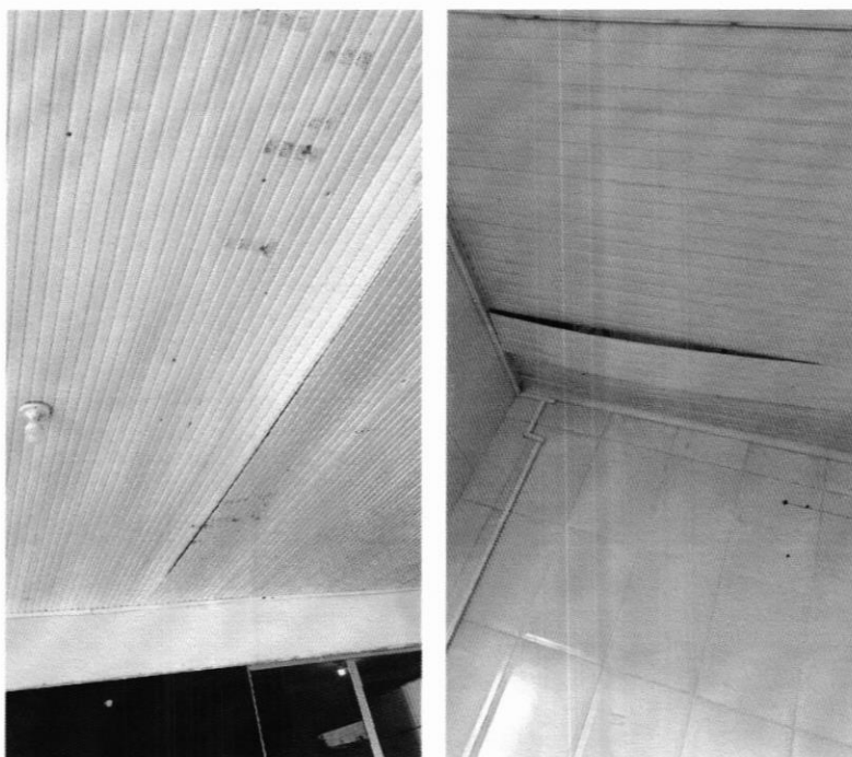
Figura 3 – Forro de PVC sujo e alguns precisando de manutenções.
