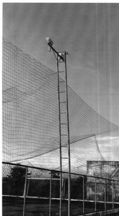
Figura 13 – Parte elétrica da quadra de esporte furtado e sem energia elétrica.
