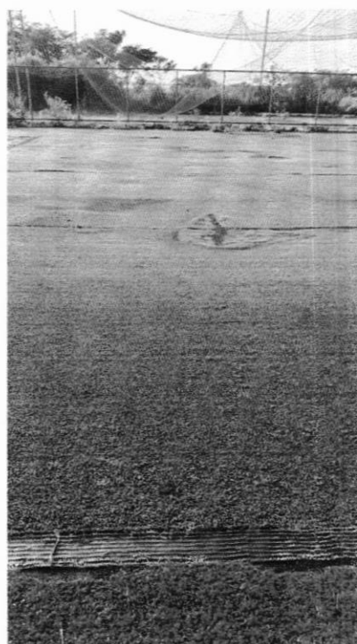
Figura 14 – Piso da quadra de esporte completamente deteriorado.
