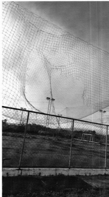
Figura 12 – Rede de quadra de esporte danificada.
