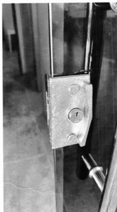
Figura 6 – Fechadura de porta de vidro deteriorada .
